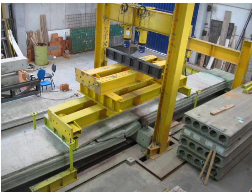
Figura 5.36 – Vista panorâmica de EM2 após a ruptura.
