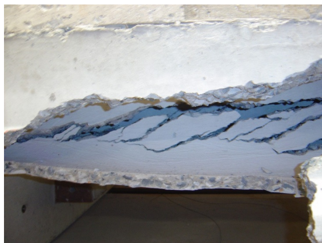
Figura 5.24 – Inclinação das fissuras diagonais decorrentes das solicitações tangenciais para a ruptura de EM1. Foto tirada no lado de referência.
