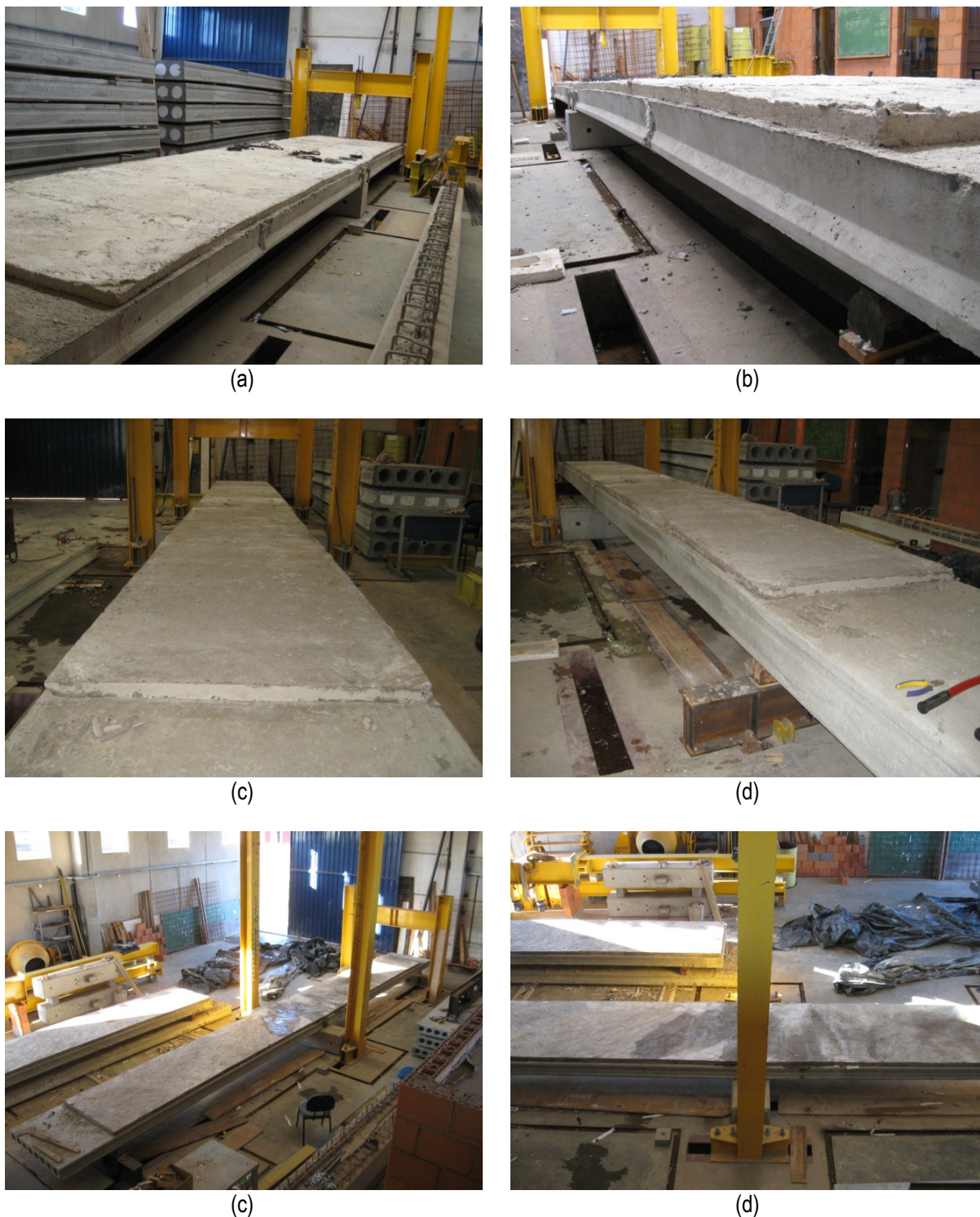
Figura 5.12 – Modelos após a concretagem da capa: (a) EM1; (b) Regularidade da capa de EM1; (c) EM2; (d) Regularidade da capa de EM2; (e) EM3; (f) Regularidade da capa de EM3.
