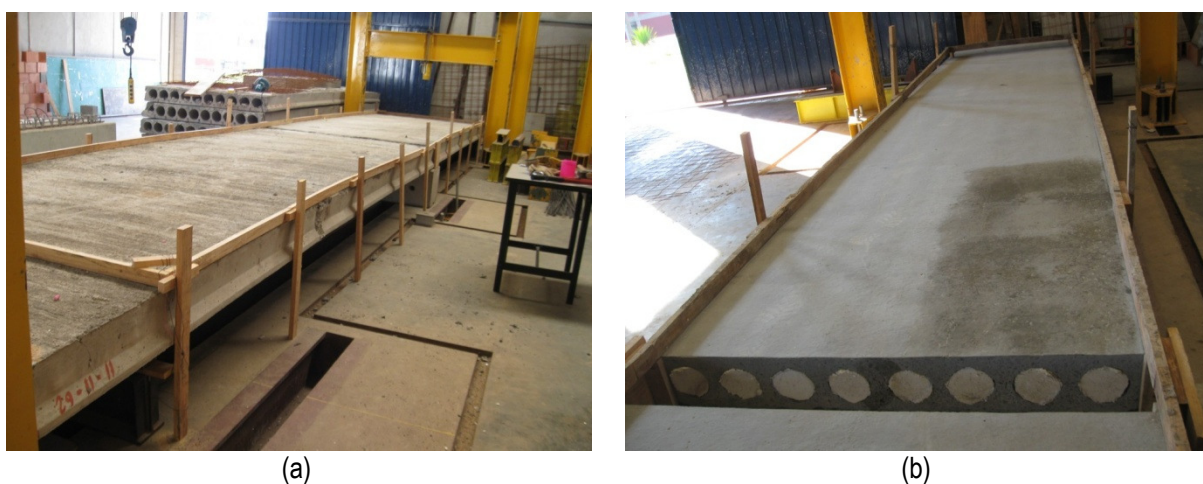
Figura 5.8 – Preparo das formas e limpeza da superfície da laje: (a) Formas de madeira para concretagem da capa (EM1); (b) Limpeza da superfície com pano úmido (EM3).
