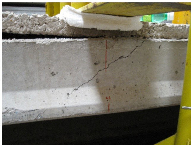
Figura 5.26 – Fissura ocasionada pelo momento positivo (EM1). Foto tirada no lado de referência, na laje que sofreu ruptura.
