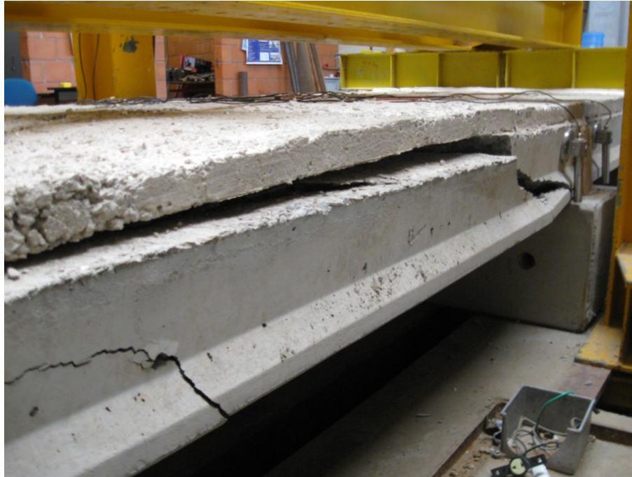
Figura 5.23 – Vista lateral da laje que sofreu ruptura no EM1. Laje da direita com relação ao lado de referência. Foto tirada no lado oposto.
