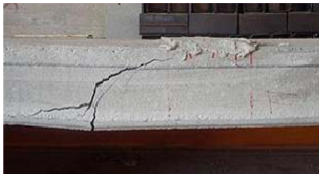
Figura 4.8 – Fissuras caracterizando interação de flexão com cisalhamento. (Fonte: COSTA (2009)).
