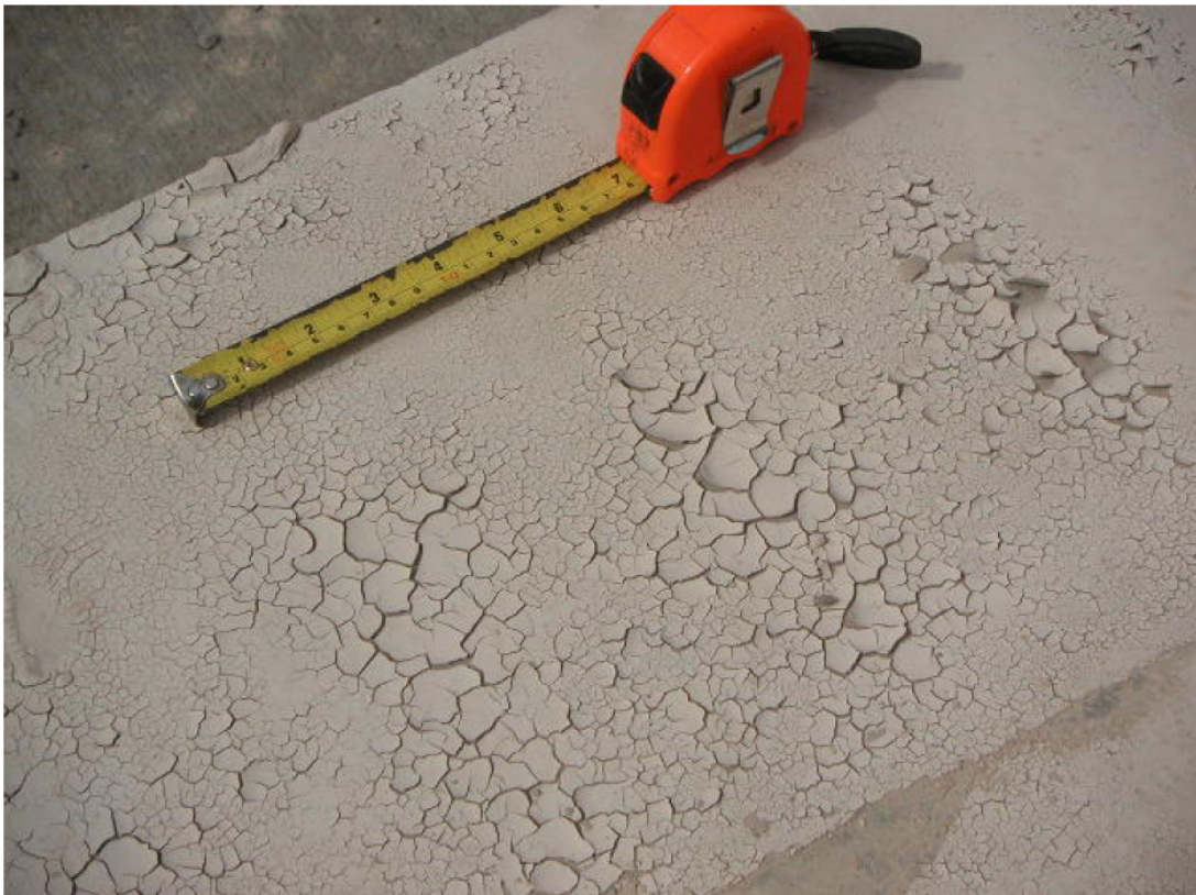
Figura 7.2 – Nata de concreto presente nas extremidades das lajes alveolares devida ao processo de corte das unidades (IBRAHIM (2008)).
