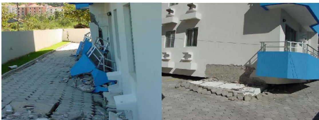
Figura 1.4 – Ruptura do sistema de sustentação (SOUZA, 2003).
