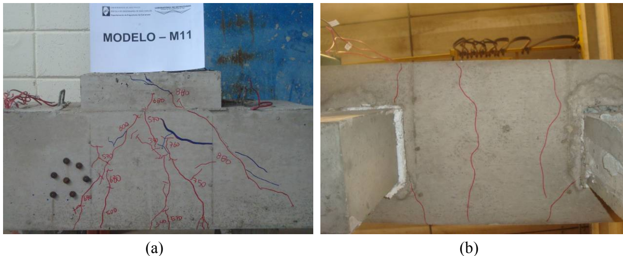
(a) (b) Figura 5. 73–Fissuras na face lateral e inferior do Modelo M11
