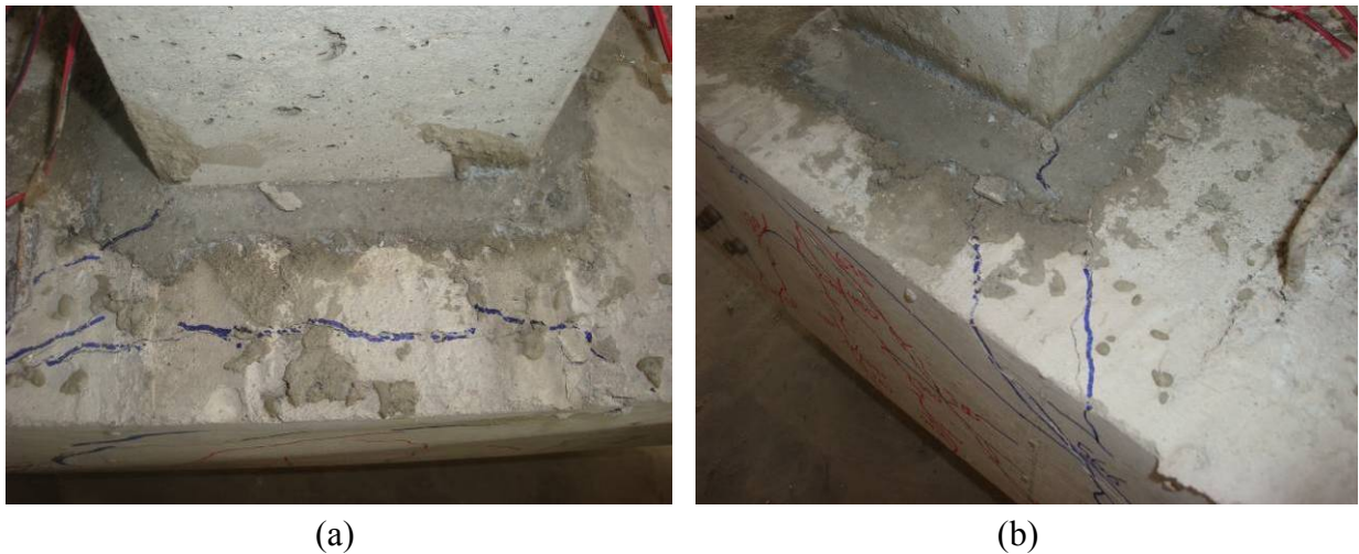
Figura 5. 126–Fissuras nas paredes do cálice do Modelo M14
