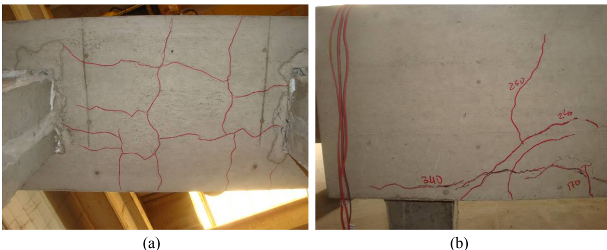
Figura 5. 94–Fissuras na face inferior e destacamento do concreto no Modelo M6
