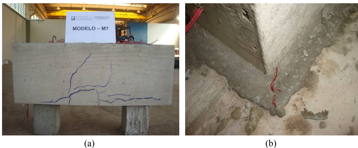
Figura 5.105–Fissuras na face inferior e lateral oposta do Modelo M7
