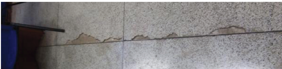
Figura 16 - Revestimentos em granilite com deslocamentos – IQSC (quadros de 1,5 m x 1,5 m).
