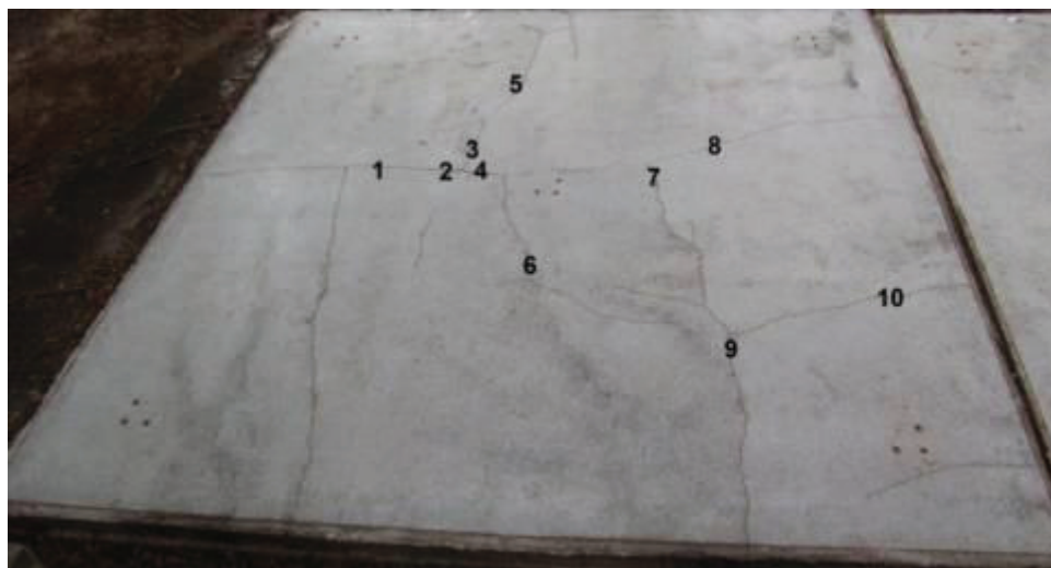
Figura 59 - Quadro I com as marcações dos pontos de leitura de abertura de fissura.
