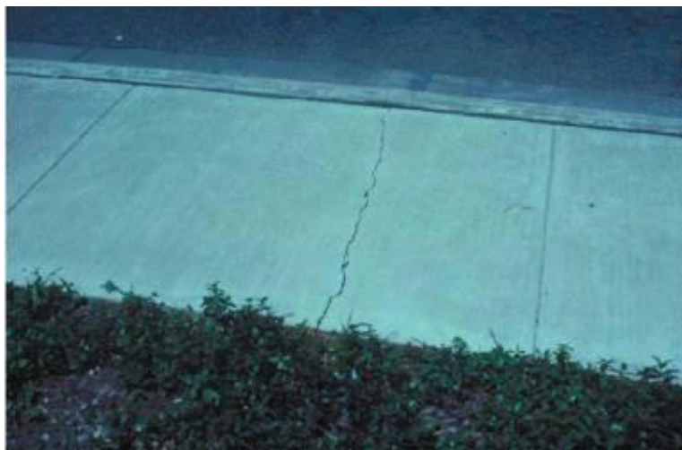
Figura 26 - Fissura de retração por secagem a longo prazo 4 .
