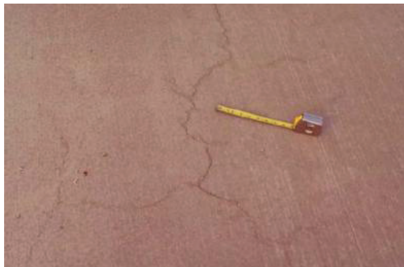
Figura 27 - Fissura por movimentação térmica 5 .
