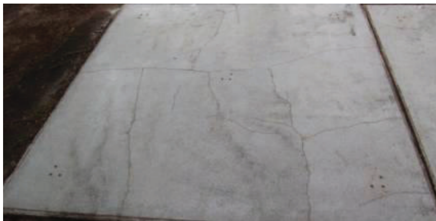
Figura 58 - Evolução das fissuras no Quadro I decorrido um mês do surgimento da primeira fissura.
