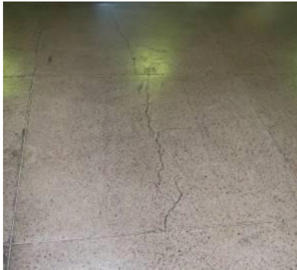
Figura 2 - Quadros em granilite fissurados.
