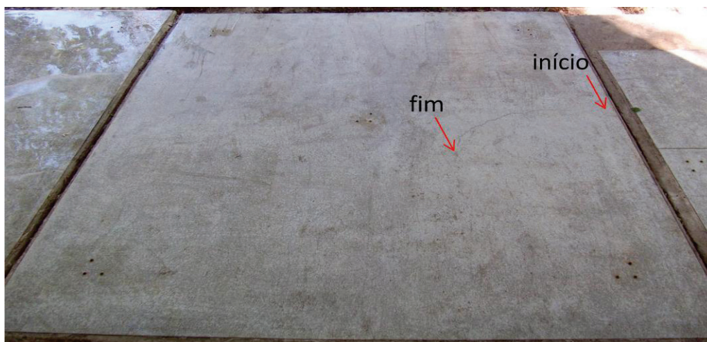
Figura 64 - Microfissura no Quadro II.
