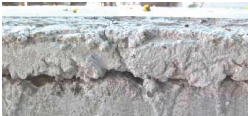
Figura 61 - Quadro I fissurado e com deslocamento em relação à base do conjunto granilite e argamassa de regularização.
