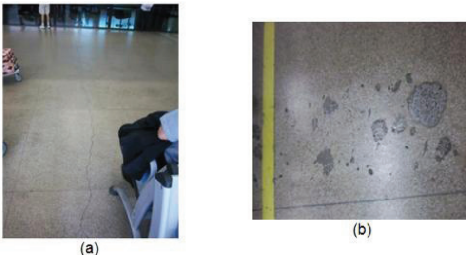
Figura 14 - Fissuras em granilite - Aeroporto 2 . (a) fissura atravessando quadros de 1,5 m x 1,5 m; (b) vários reparos em um quadro.
