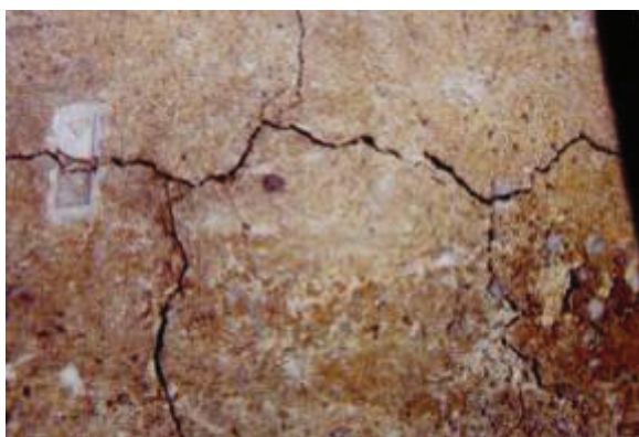
Figura 25 - Fissuras por reações álcali-agregado 3 .
