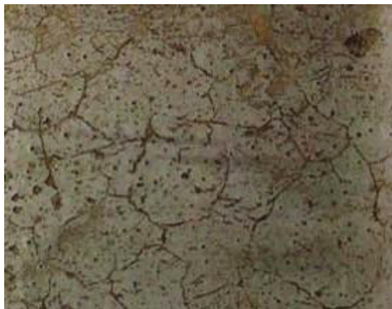
Figura 17 - Fissuras por retração plástica. Fonte: MEHTA & MONTEIRO (2008).
