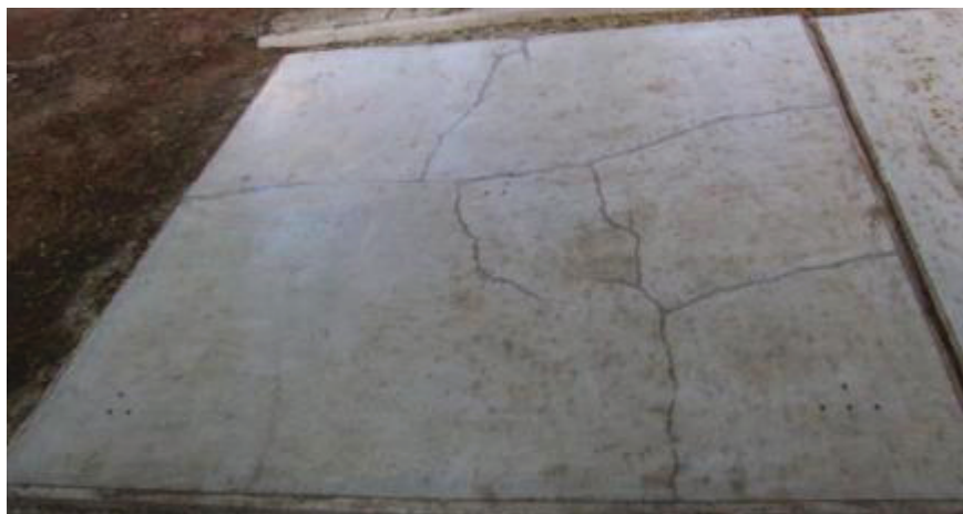
Figura 57 - Primeiro registro de fissuras no Quadro I – 8 dias de idade.
