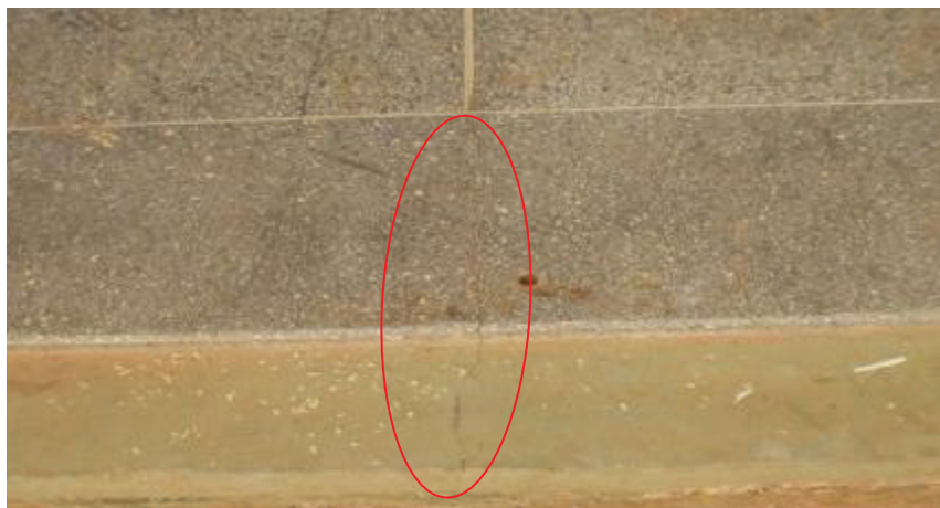
Figura 15 - Detalhe de substrato e granilite fissurados. Fonte: LIBORIO (2009).
