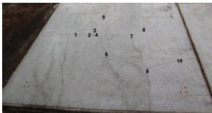
Figura 79 – Posicionamento dos pontos de análise de abertura de fissuras.
