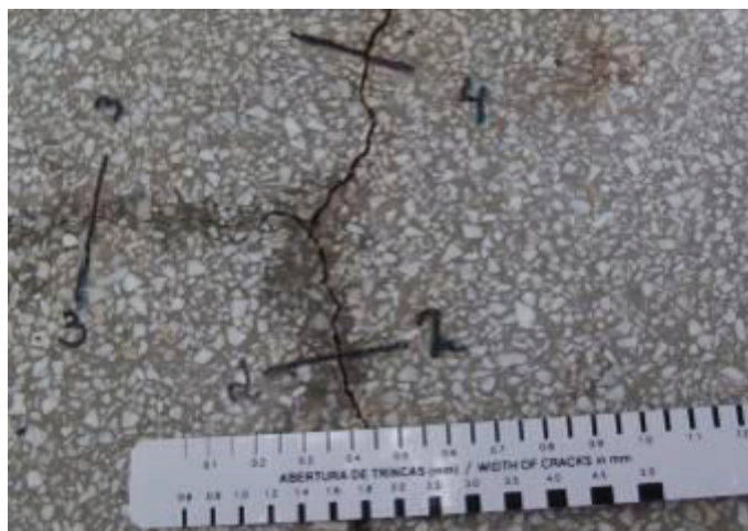
Figura 60 - Detalhe dos pontos 2, 3 e 4 e do fissurômetro.
