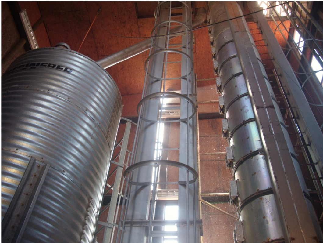
Figura 3.14 - Visão geral silo de armazenamento e silo-piloto
