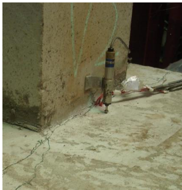
Transdutor na capa da laje
