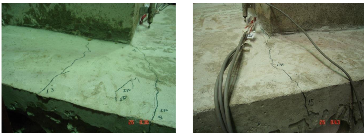
Figura 4.10 – Fissuração da capa da laje durante o ensaio da primeira etapa.
