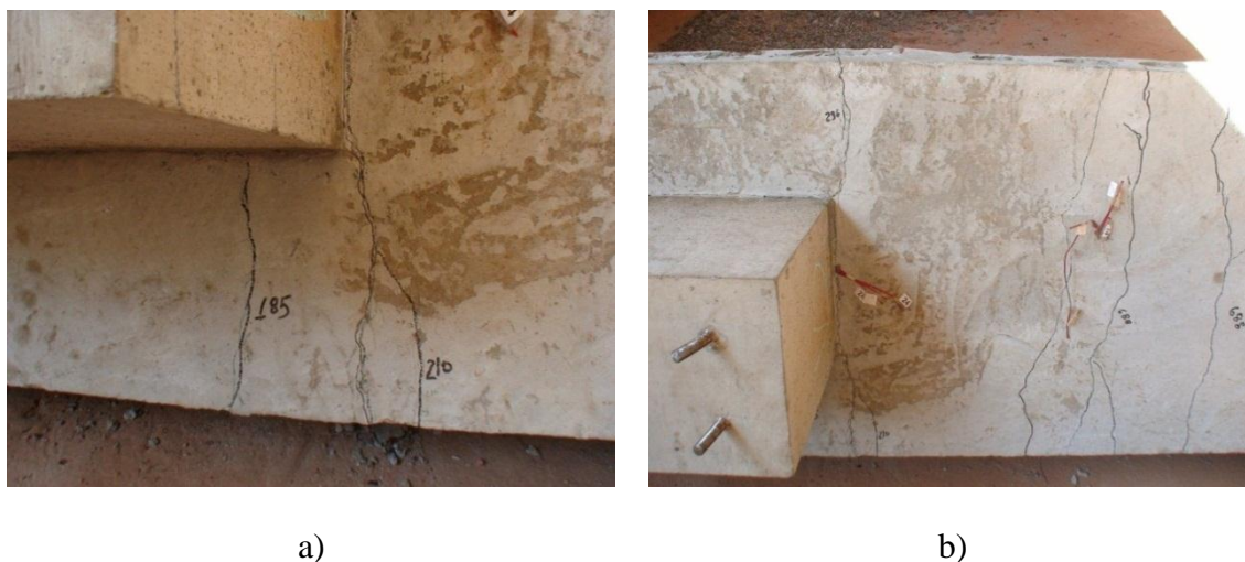
Figura 4.22 – Detalhe das fissuras na capa da laje.
