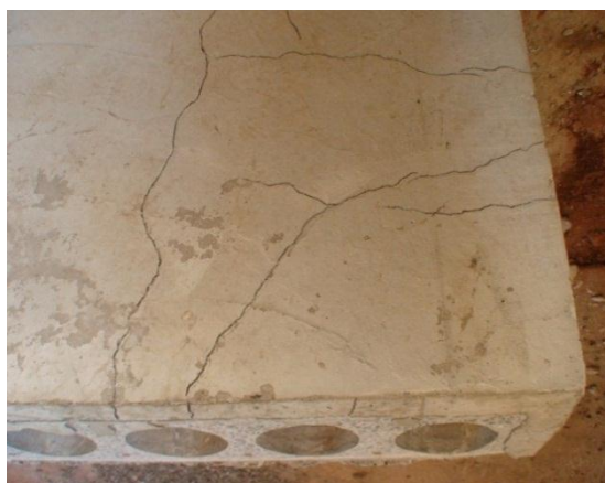
Figura 4.23 – Mudança de direção das fissuras próximas ao apoio.
