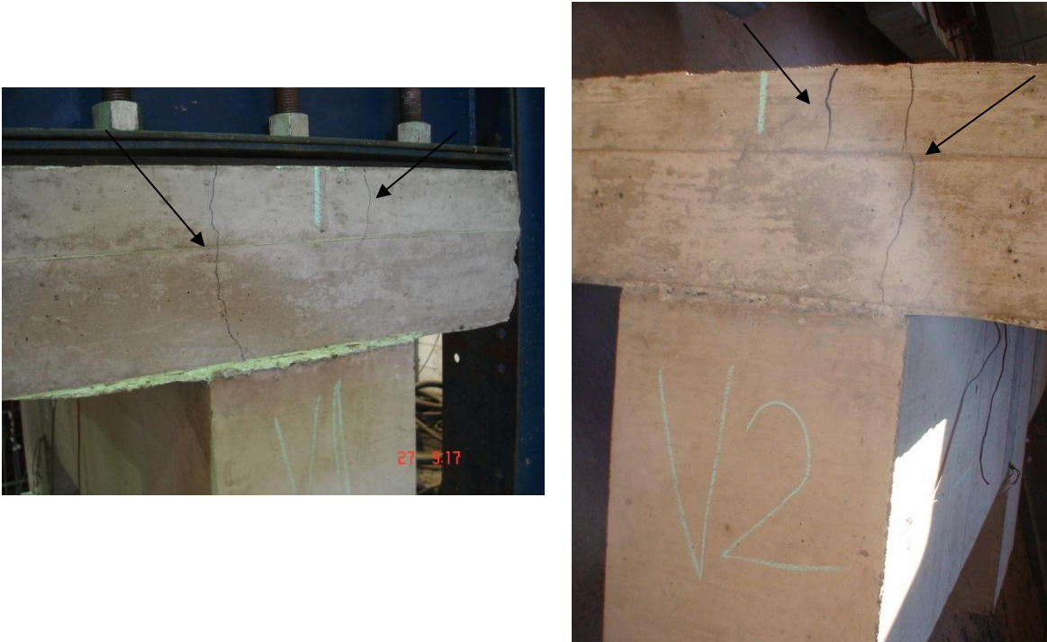
Figura 4.24 – Detalhe das fissuras verticais na laje nos dois apoios.
