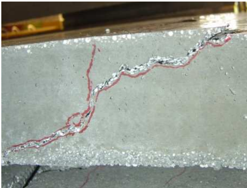
Figura 5.24 – Detalhe da ruína do modelo L 3 A por ação da força cortante.
