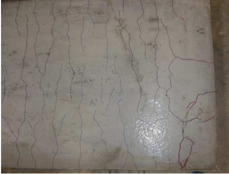
Figura 5.18 – Fissuras por escorregamento das barras do modelo L 2 A .
