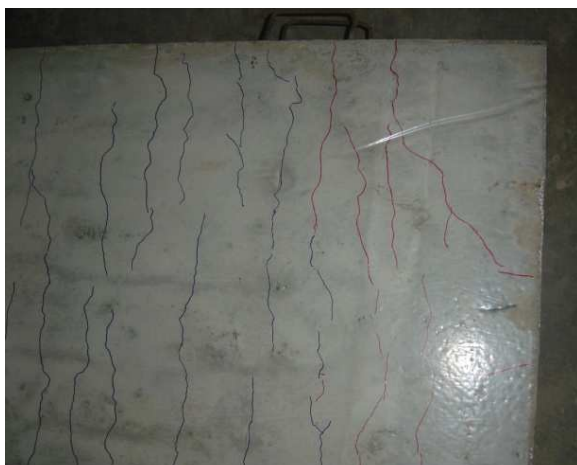
Figura 5.14 – Fissuras por escorregamento das barras do modelo L 1 B .
