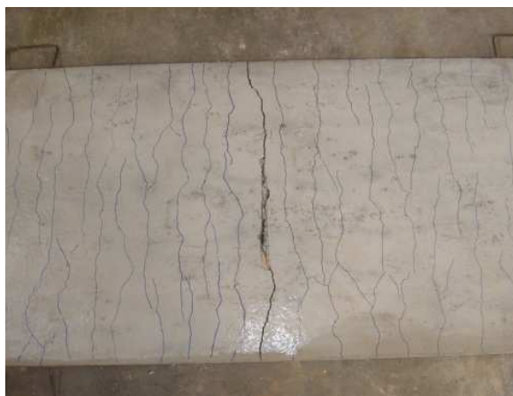
Figura 5.16 – Fissuras de momento fletor na região central do modelo L 2 A .
