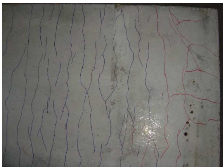
Figura 5.30 – Fissuras de escorregamento das barras do lado direito do modelo L 3 B.
