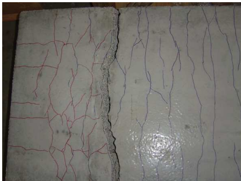
Figura 5.29 – Fissuras de escorregamento das barras do lado esquerdo do modelo L 3 B.
