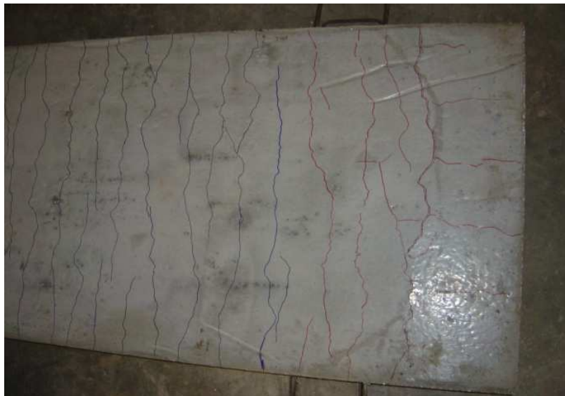
Figura 5.22 – Fissuras por escorregamento das barras do modelo L 2 B.
