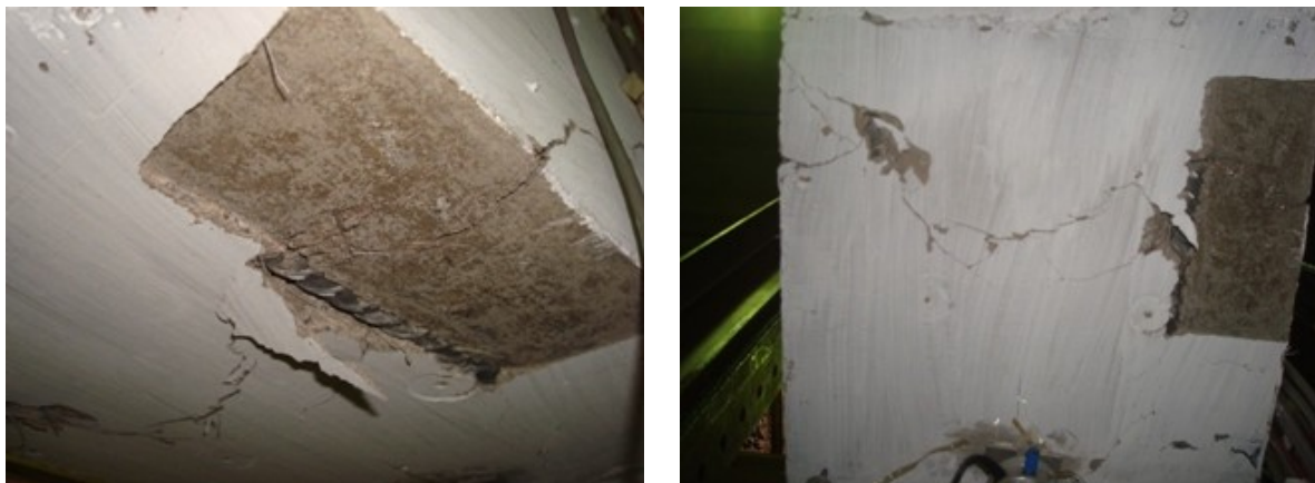
Figura 7.3 – Ruptura do cobrimento no modelo de concreto pré-moldado.
