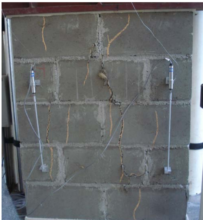
Figura 4.13: Propagação de fissuras verticais de tração
