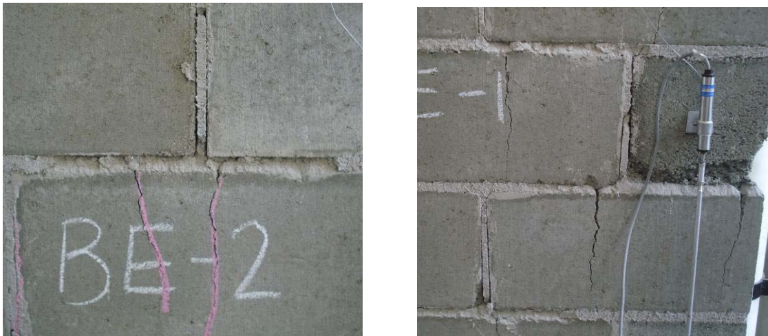
Figura 4.15: Esmagamento da argamassa
