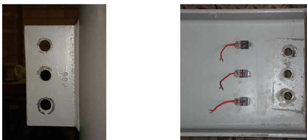
Figura 5.7 - Fotos do alargamento dos furos da chapa de ligação e da alma.
