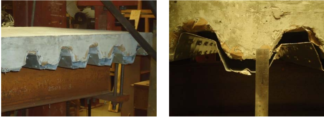
Figura 3-75 – Descolamento da laje e a viga do Modelo 3.
