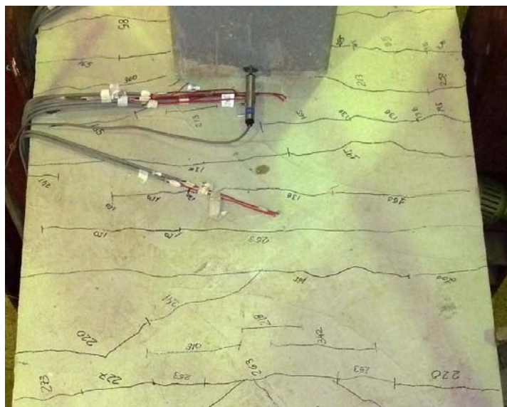
Figura 3.98 – Fissuração da capa – modelo 3.
