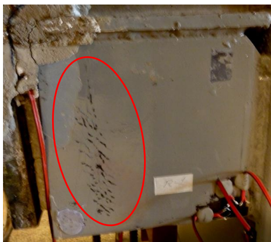
Figura 3.136 – Região do consolo da qual a tinta foi arrancada quando atuou o momento positivo.
