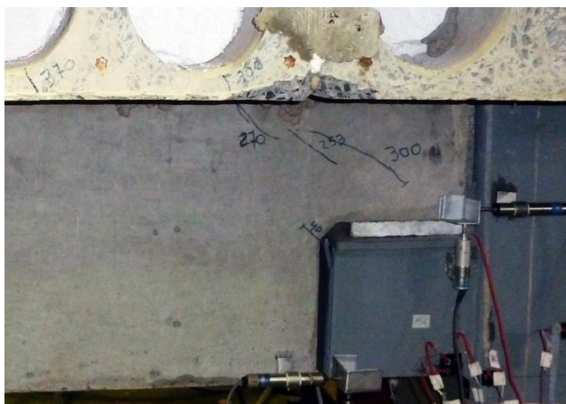
Figura 3.99 – Fissuração da viga – modelo 3.
