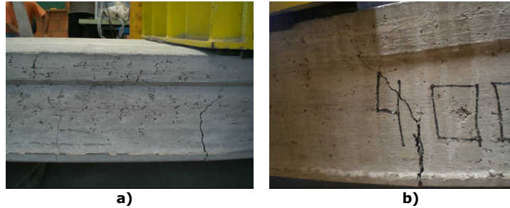
Figura 6.26: Fissuração da laje L21-S-21-7D9,5-W_C. a) Face oposta; b) Face frontal.
