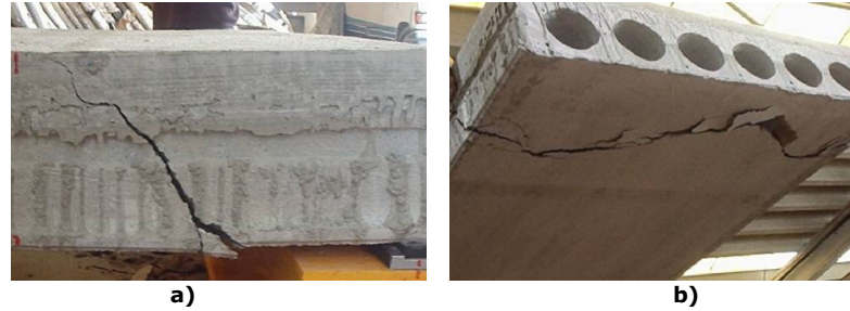
Figura 7.10: Exemplo de configuração de fissuração de laje com capa de concreto reforçado com fibras, proveniente do lote Z. a) Vista lateral; b) Vista inferior.
