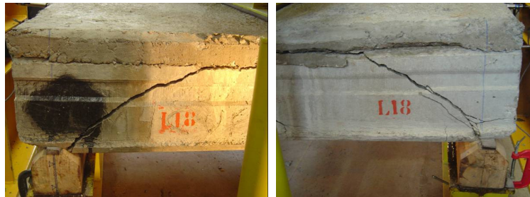
Figura 7.6: Fissuração da laje L6-C-25-6D12,7-Y_C.
