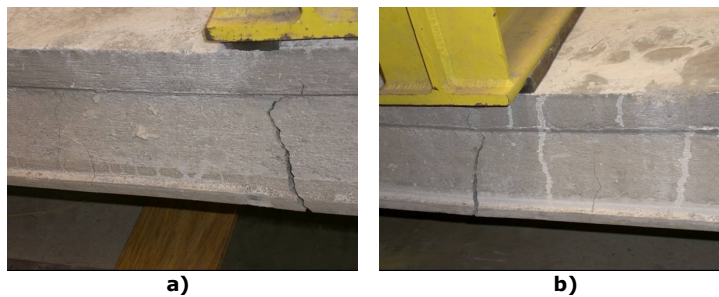
Figura 6.28: Fissuração da laje L24-S-16-5D9,5-W_C. a) Face oposta; b) Face frontal.
