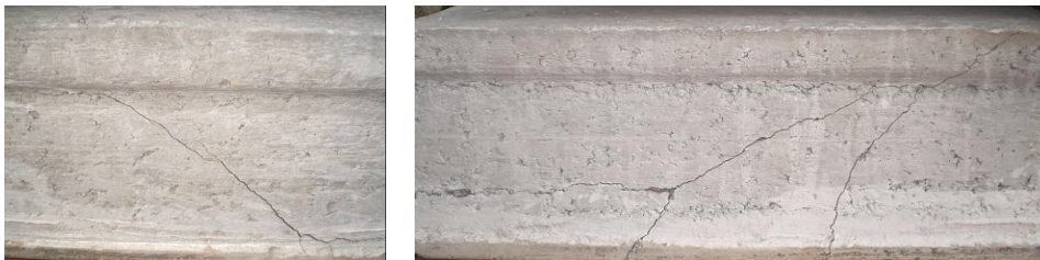
Figura 6.21: Fissuração da laje L28-S-26-9D9,5-W_C. a) Face oposta; b) Face frontal.
