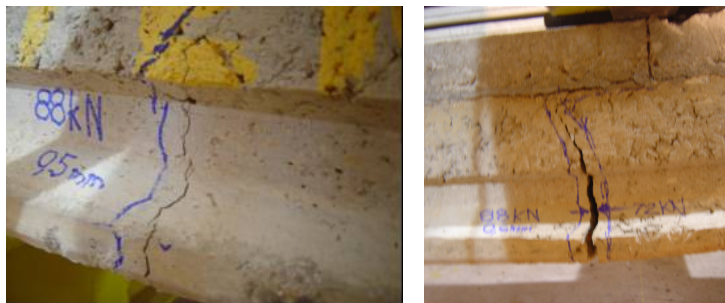
Figura 7.2: Configuração de fissuração da laje L1-C-20-6D9,5-X_C.
