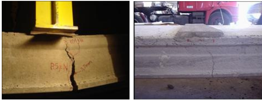
Figura 3.6: Fissuras de flexão em elementos de laje alveolar.
