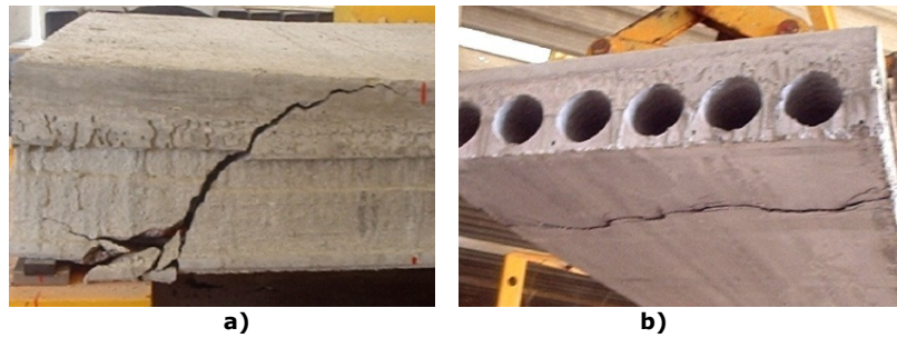
Figura 7.8: Exemplo de configuração de fissuração de laje com capa, do lote Z. a) Vista lateral; b) Vista inferior.
