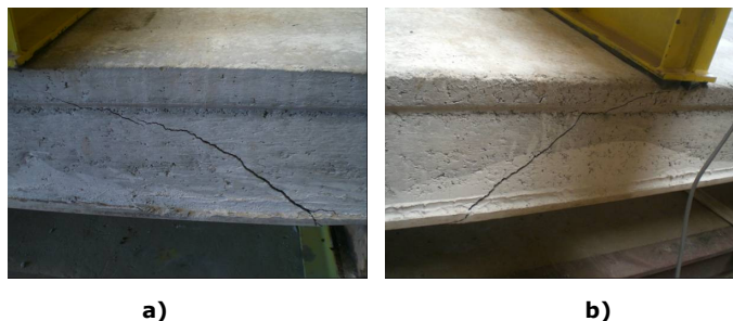
Figura 6.22: Fissuração da laje L29-S-26-9D12,7-W_C. a) Face oposta; b) Face frontal.
