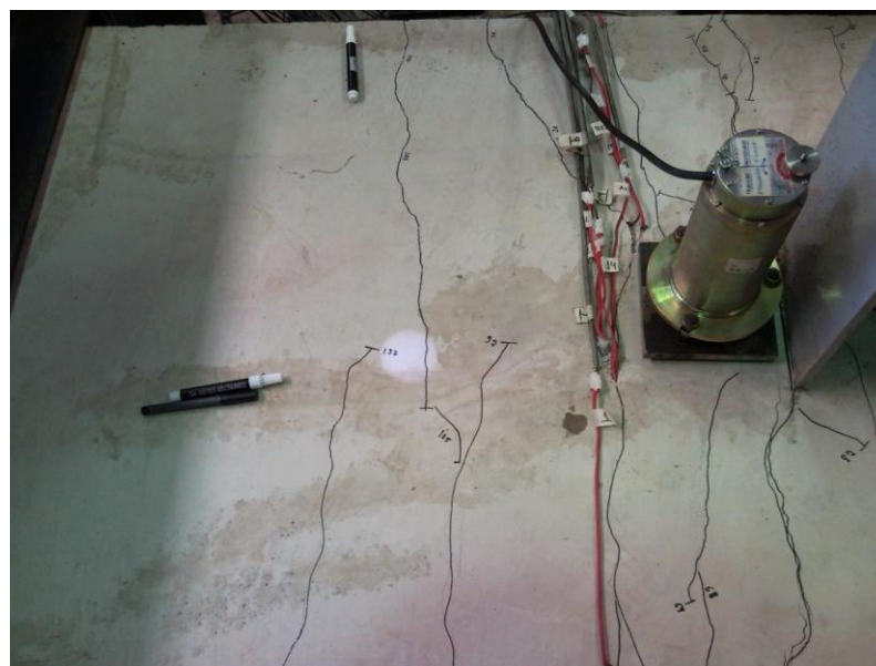
Figura 4.16 – Configuração final da fissuração na laje
