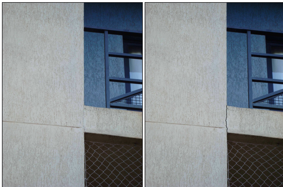
Figura 3.14 - Fissura vertical em encontro de laje de piso e parede.
