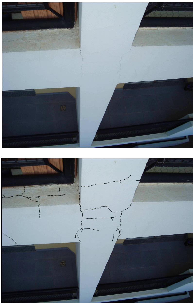
Figura 3.35 - Fissuras causadas pelo carregamento das lajes.
