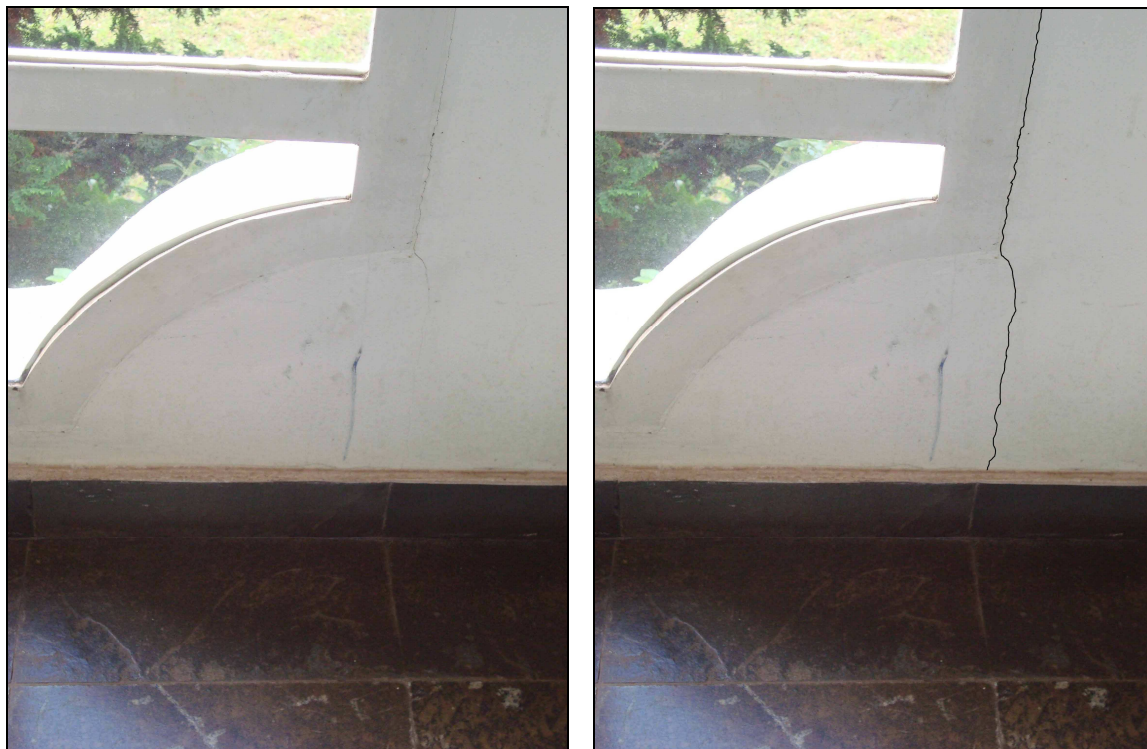
Figura 3.18 - Fissuras internas em cantos inferiores de aberturas de janelas.
