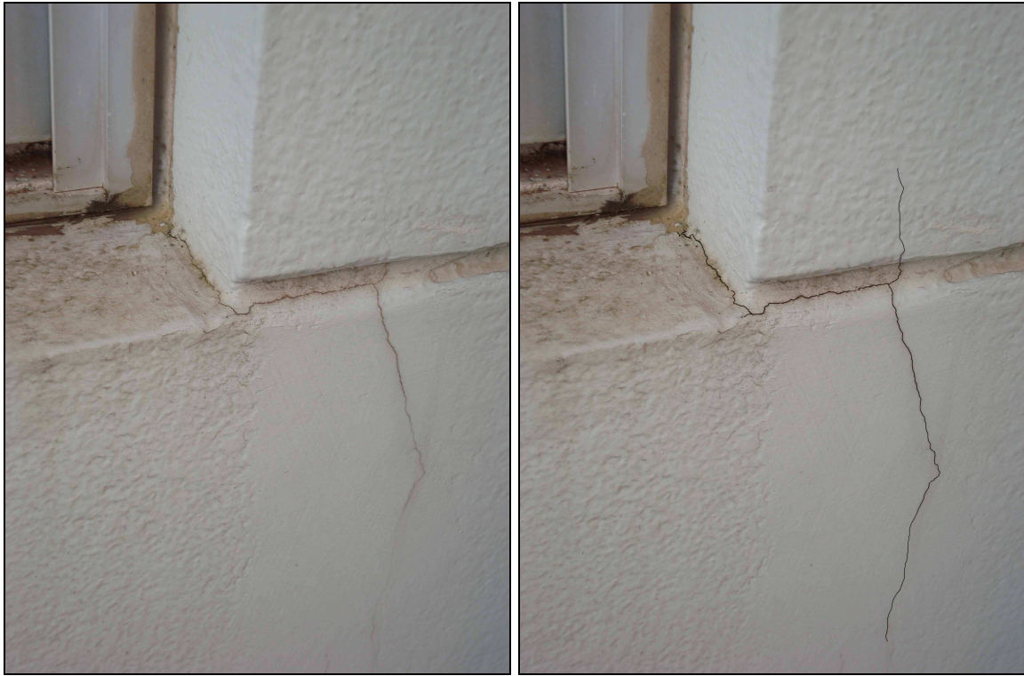
Figura 3.32 - Fissuras em canto de abertura de janela.
