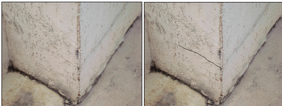
Figura 3.24 - Fissura em encontro de paredes em alvenaria estrutural.
