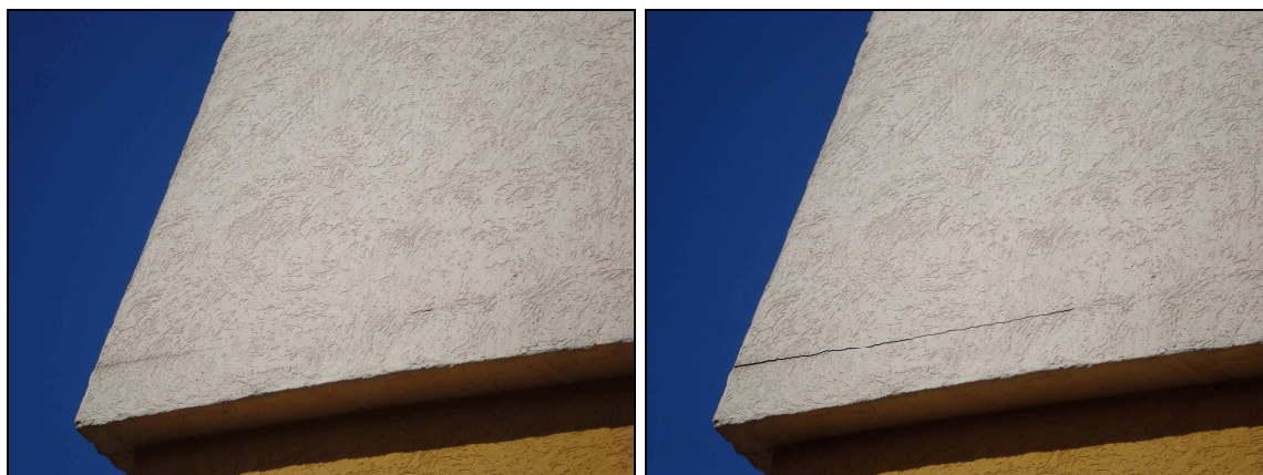
Figura 3.30 - Fissura horizontal ao longo da laje.
