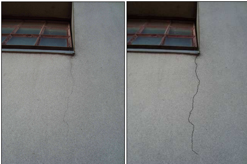
Figura 3.2 - Fissura em canto inferior de abertura de janela em parede externa.
