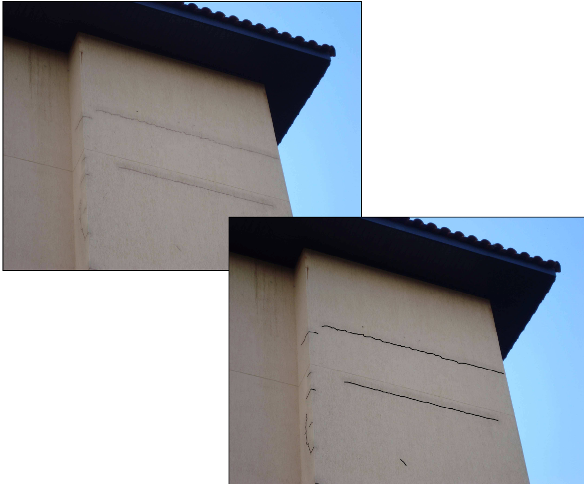
Figura 3.11 - Fissuras horizontais na altura da laje e à meia altura da parede.
