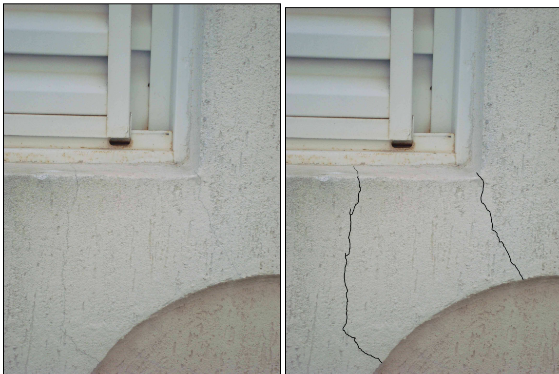
Figura 3.19 - Fissuras externas em cantos inferiores de aberturas de janelas.
