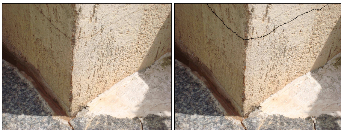
Figura 3.25 - Fissura ao longo da base da parede de alvenaria estrutural.
