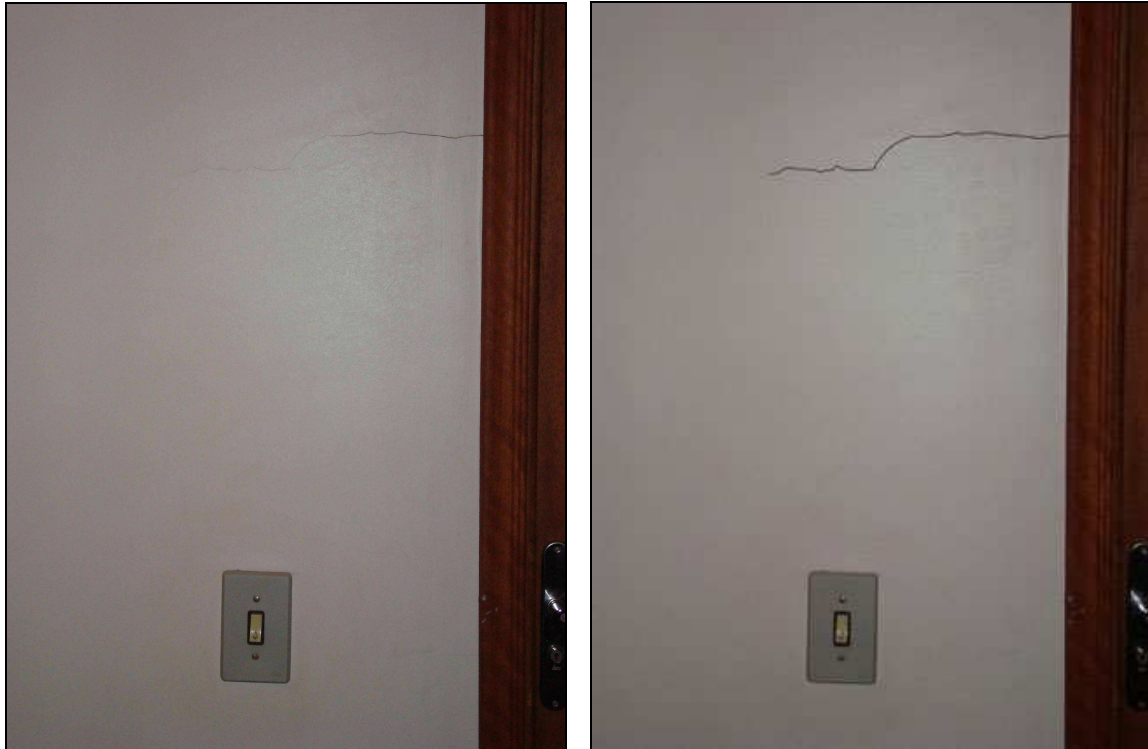
Figura 3.8 - Fissura horizontal na lateral de vão de porta.
