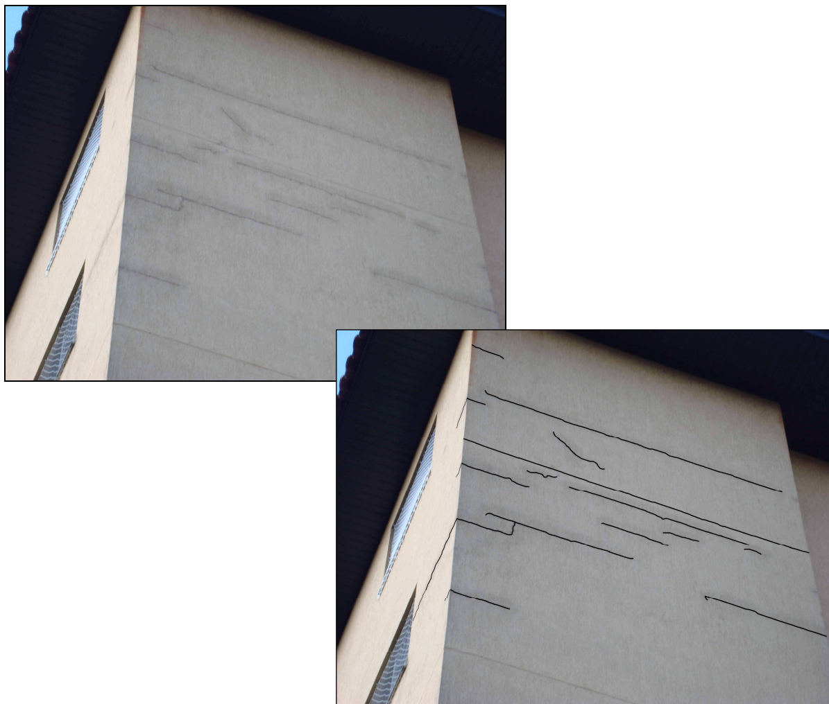
Figura 3.12 - Fissuras horizontais na altura da laje e à meia altura da parede.
