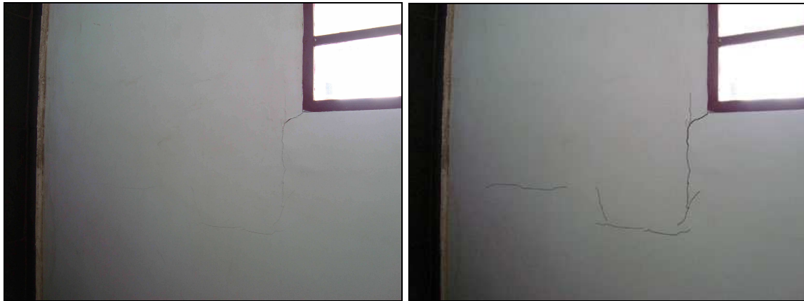
Figura 3.4 - Fissuras em cantos inferiores de aberturas de janelas.
