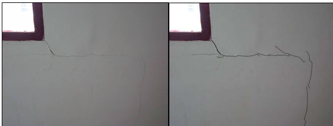
Figura 3.3 - Fissura em canto inferior de abertura de janela em parede interna.
