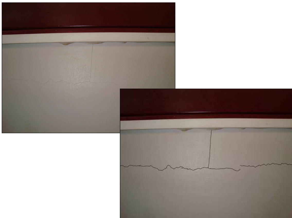
Figura 3.7 - Fissura na parte inferior da abertura de uma janela.
