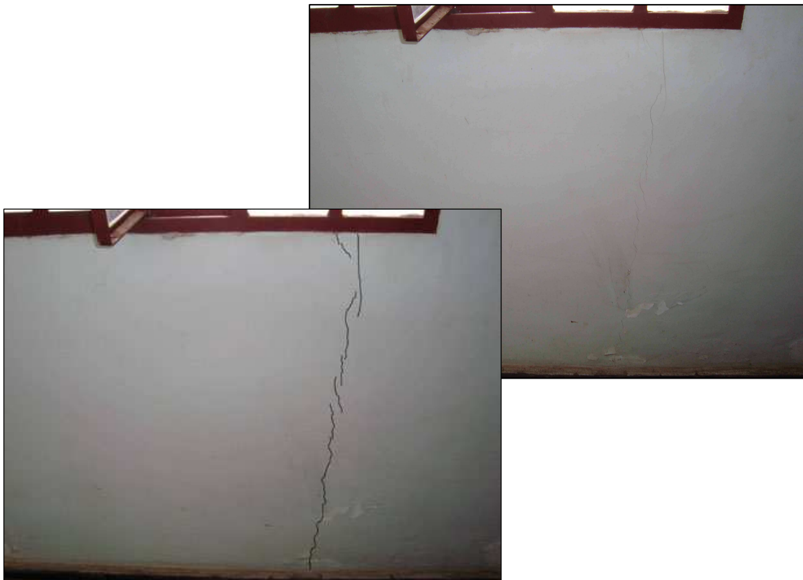
Figura 3.5 - Fissura vertical na parte inferior da abertura de uma janela.
