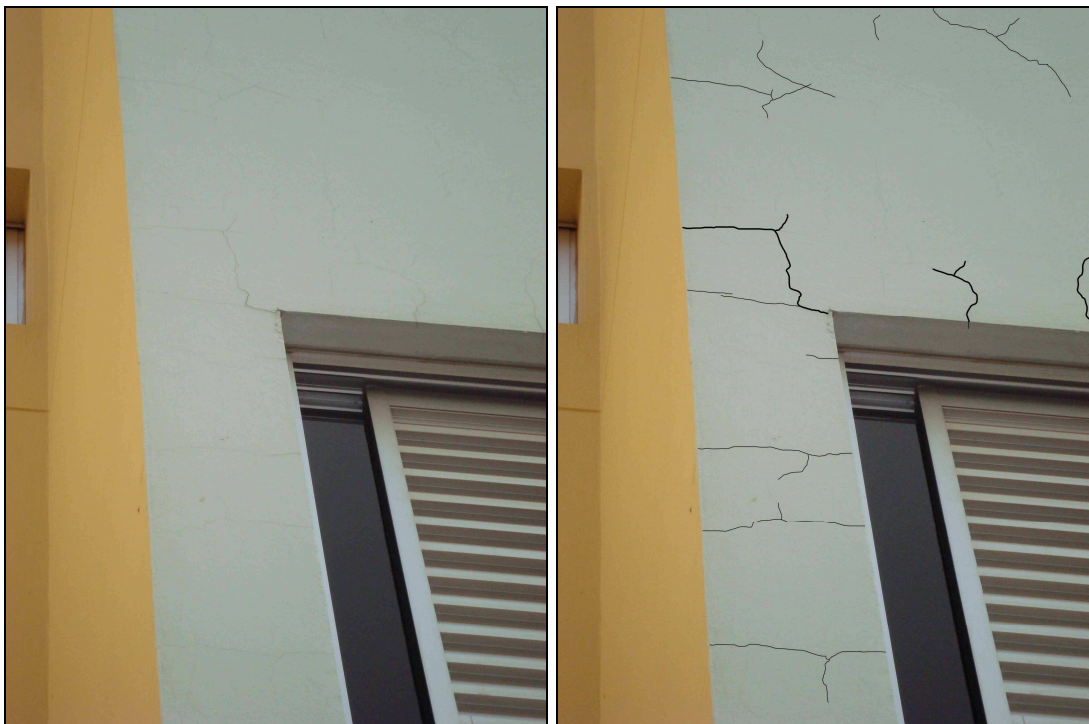
Figura 3.34 - Fissuras nos cantos superiores de aberturas de janelas.
