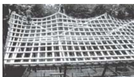
Sistema estrutural da cobertura tipo grelha com peças de madeira roliça de pequeno diâmetro.
