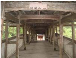
Vista interna da estrutura do pórtico de cobertura da passarela. Colunas de madeira roliça, vigas de madeira serrada.
