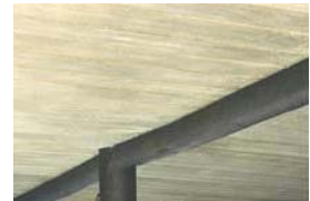
Estrutura da laje de concreto pré-moldado, apoiada sobre às vigas de madeira roliça de eucalipto.
