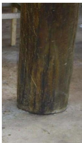
Concentração de umidade por capilaridade na interface fundação coluna.
