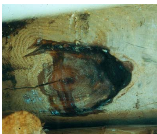
a) Sinais de apodrecimento ao redor do Nó
