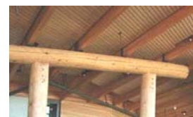
Tops das colunas do pórtico. Estrutura da cobertura com vigas de madeira serrada.
