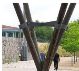
Detalhe do contraventamento da estrutura de apoio da cobertura, com 4 colunas inclinadas em V, situada ao lado esquerdo da edificação.
