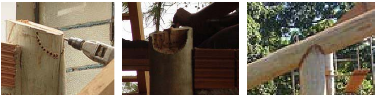
Figura 4.1: Confecção da ligação p/ entalhe, de encaixe cilíndrico, no topo da peça.
