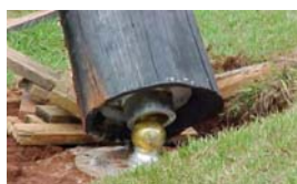
Posicionamento da base do poste na placa de base de aço articulada, chumbada no bloco de fundação.
