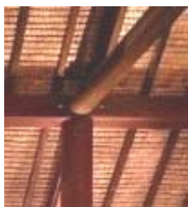
Conexão da coluna de madeira roliça e vigas de madeira roliça e serrada.
