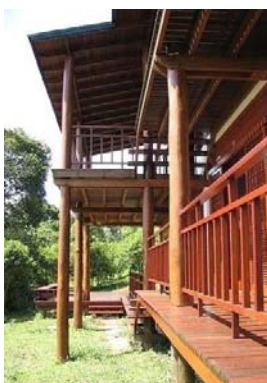
Condomínio Sítio da Tribo V: vigas compostas de duas peças de madeira serrada externas, conectadas no topo da Coluna de madeira roliça.
