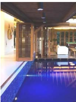
Ao fundo, mão francesa que apóia a viga de sustentação do pergolado sobre a piscina.
