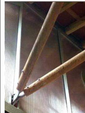
Detalhe da conexão das bases das escoras da estrutura da cobertura e do pórtico em arco inclinado da fachada principal.
