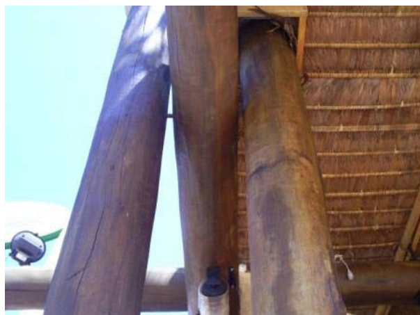
Vista inferior da conexão cujo tipo de ligação é simplesmente um pino metálico unindo à viga às duas colunas que são engastadas no solo.
