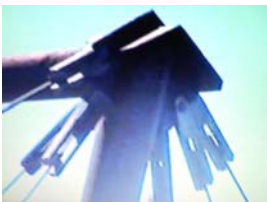
Placa de fixação dos estais.
