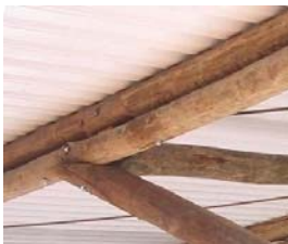
Emenda próxima ao nó, na viga superior de dupla seção no primeiro trecho.
