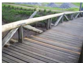
Guarda corpo que compõem os contraventamentos em X da estrutura treliçada da passarela.
