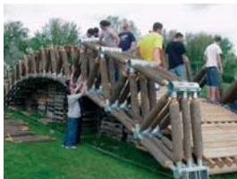
Montagem da treliça em arco, com os segmentos de elementos estruturais de peças roliças de madeira, nos conectores especiais.
