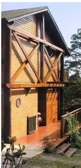
Condomínio Sítio da Tribo II: Colunas de madeira roliça, contraventadas com treliças em X, constituídas por vigas compostas de duas peças de madeira serrada externas.
