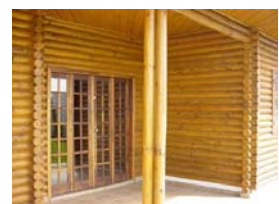
Colunas de peças roliças, com seção composta tripla e vigas com seção composta dupla
