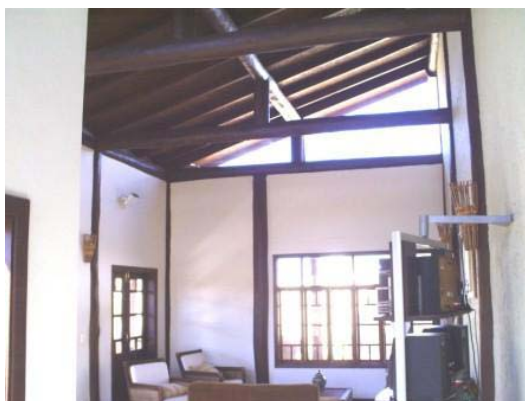
Vidro na cobertura para entrada de iluminação natural. Estrutura da cobertura da sala social.
