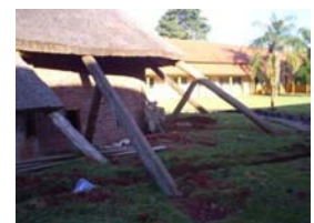
Estruturas das vigas inclinadas e escoras engastadas no solo, em outro ângulo de visão.
