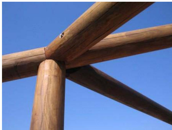
Encontro de vigas laterais e espigão. Foi usado um martelete para o espigão e barra rosqueada Ø1/2" para as vigas de travamento laterais.
