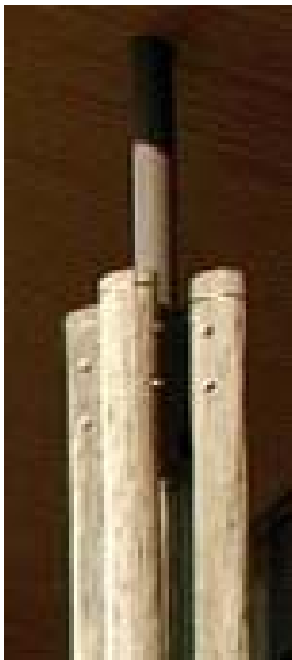
Conexão no topo da coluna de eucalipto composta de quatro postes e a interface com a estrutura metálica com perfis tubulares.
