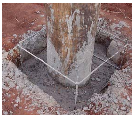
Fundação: Poste engastado em bloco de concreto armado.
