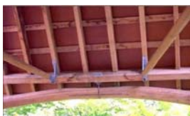
Vista inferior dos detalhes das escoras de madeira roliça de pequeno diâmetro, que suportam a estrutura da cobertura e do pórtico em arco inclinado da fachada principal.
