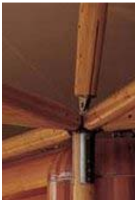
Conexões metálicas especiais, que unem os elementos estruturais de madeira roliça.
