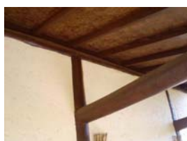
Conexão de uma das colunas centrais, da varanda com a sala social.
