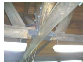
Conexões com chapas externas, dos nós da treliça do banzo inferior, com as diagonais, montantes e consoles que recebem às extremidades das peças de contraventamentos.
