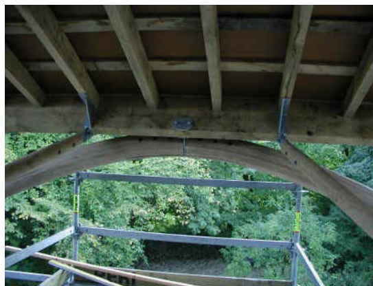
Escoramento da estrutura da cobertura da fachada, com peças de madeira roliça de pequeno diâmetro.
