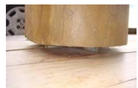
Placa de Base, coluna espaçada do contato com o piso.
