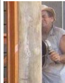
Lixamento dos elementos estruturais de madeira roliça. Preparo para aplicação de Osmocolor Stain da Montana Química.
