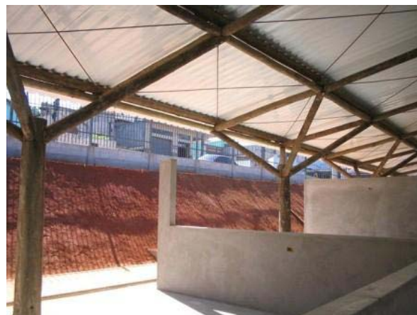
Os quadros da cobertura são contraventados com tirantes de aço de Ø5/8" (16mm).
