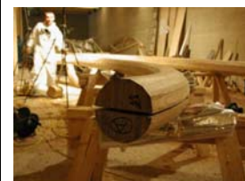
Confecção da peça estrutural de madeira laminada colada com seção circular, formando o pórtico em arco da fachada.
