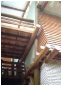
Detalhe lateral da viga dupla que suporta a estrutura do 1º piso, fixadas na coluna inclinada.
