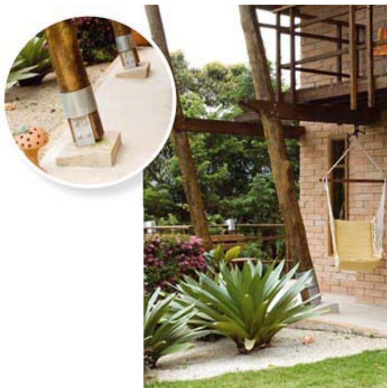
Figura 4.35: Placas de base de aço galvanizado chumbadas no bloco de fundação. Fonte: AMÁ (2009).
