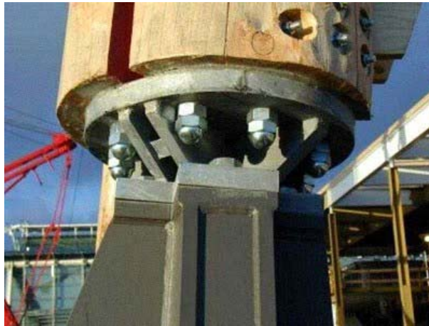
Detalhes das ligações da placa de base, de uma das colunas das torres.
