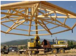
Após montada a estrutura da cobertura, a mesma é içada por caminhão munck, e instalada sobre às colunas.
