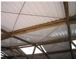
Detalhe da grelha de vigas de dupla seção com peças roliças de pequeno diâmetro e dos tirantes de aço de 16mm.
