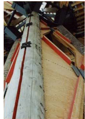
Cortes longitudinais nas colunas. Ligações das seções das colunas, com conexões metálicas, parafusos e porcas.
