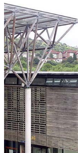
Detalhe da estrutura de treliça espacial da cobertura, fixada no topo da coluna de concreto armado, situada ao lado direito da edificação.
