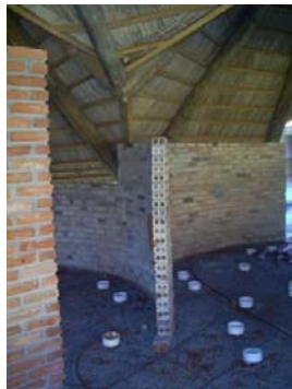
Estrutura da união do quiosque do fundo com o da lateral direita.
