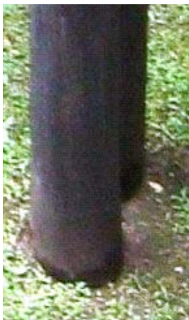
Umidade nas bases das colunas.
