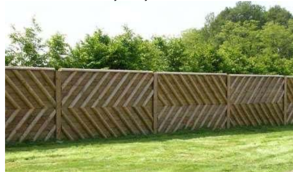
Muro de barreira acústica, c/ colunas de madeira roliça engastadas no solo. Peças inclinadas de madeira roliça para dar rigidez às paredes.
