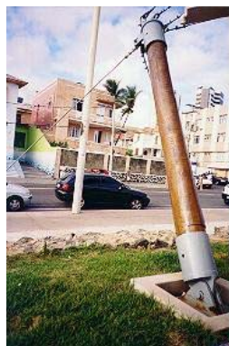
a) Poste de sustentação
