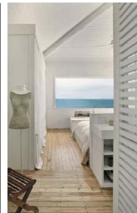
Viga inclinada da estrutura da cobertura da suíte.
