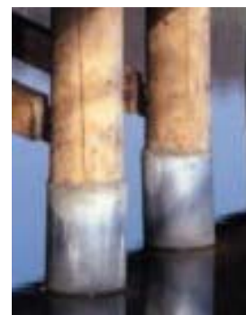
Parte das colunas submersas são protegidas com impermeabilização, a fim de aumentar a vida útil.
