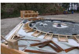
Formas dos blocos das fundações e gabaritos da estrutura da escada central.
