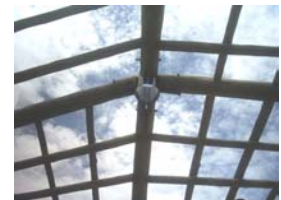
Conexão central da cobertura, porém já sem a conuna de apoio para o processo de montagem.
