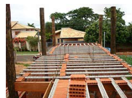
Trilhos das lajes pré-fabricadas treliçadas, apoiadas sobre as vigas serradas, de seção retangular, que compõem o piso do pavimento superior.
