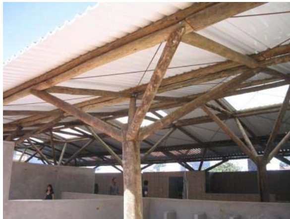
Sistema estrutural em árvore com peças roliças de madeira de pequeno diâmetro, apoiadas nas colunas.
