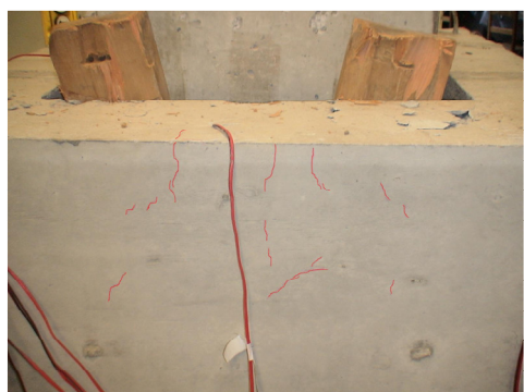
Figura 4.24 - Fissuras na parede transversal frontal
