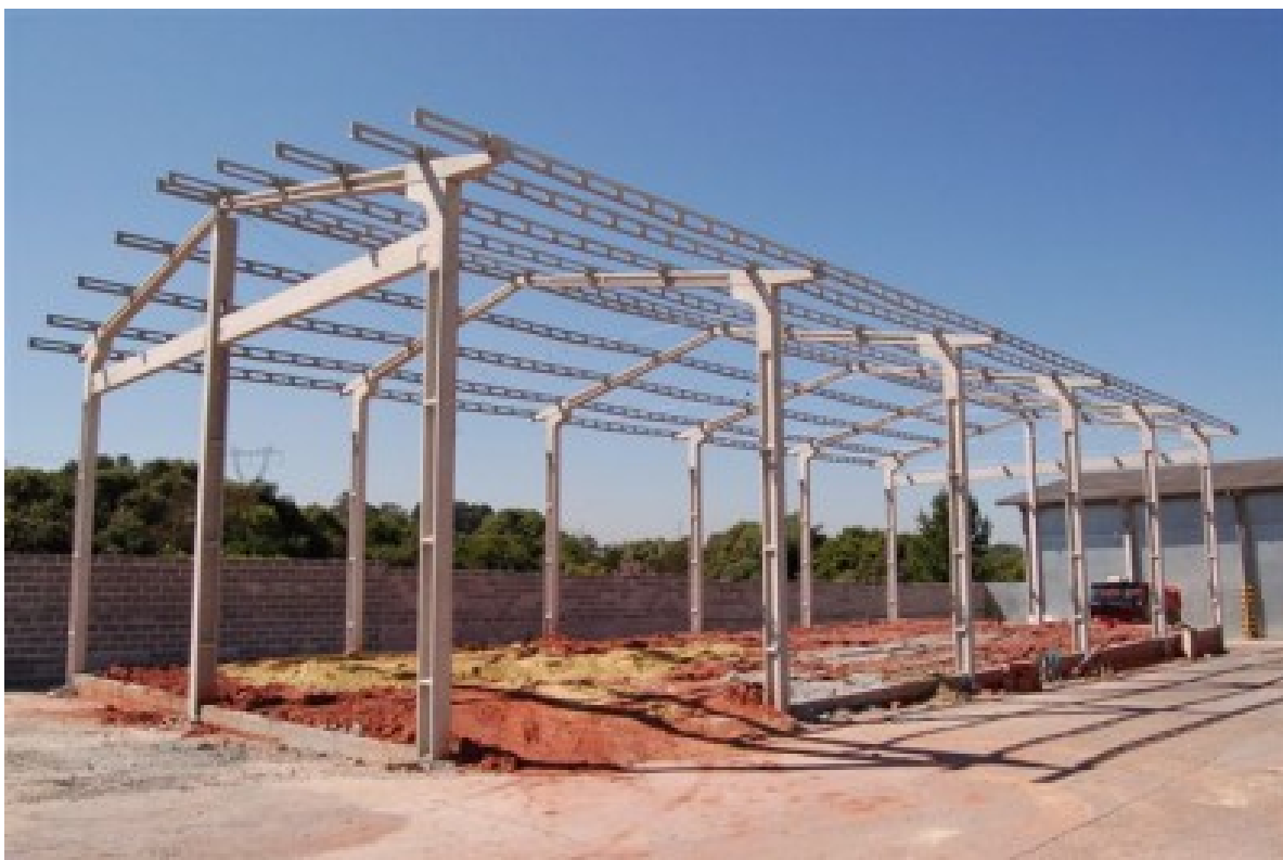
FIGURA 2.7 – Obra sendo executada com o sistema de ligação viga-pilar com chumbadores e consolo inclinado. (Fonte: www.projepar.com.br ).
