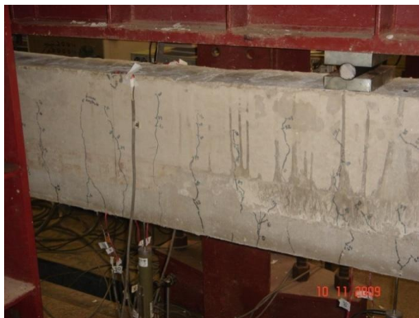
c) aspecto da distribuição das fissuras na viga do grupo C
