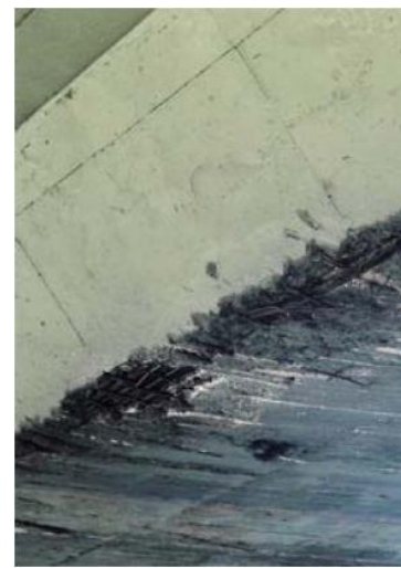
d) detalhe das armaduras expostas no Viaduto Santo Amaro
