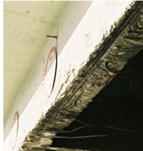
b) detalhe das armaduras expostas na Ponte do Limão
