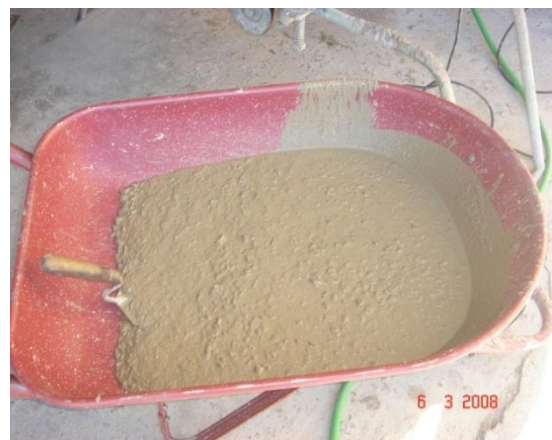
b) aspecto do concreto
