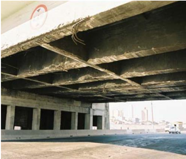
a) Ponte do Limão: barras de aço expostas
