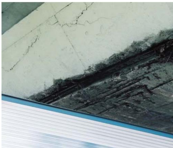
c) Viaduto Santo Amaro: armaduras expostas pelos choques dos caminhões
