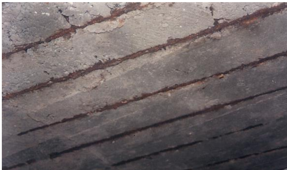
Figura 3.1 - Laje com quadro patológico avançado
