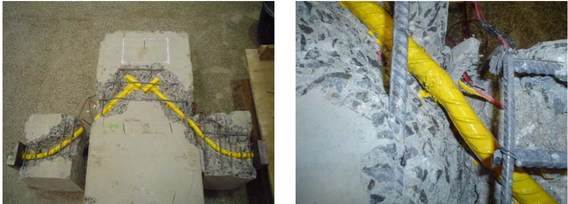
Figura 4.5: Detalhe do chumbador após a ruptura
