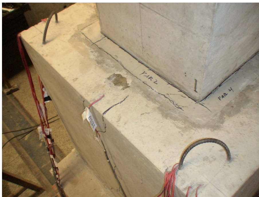
Figura 4.4: Descolamento da junta entre os elementos constituintes da ligação do Modelo IL5
