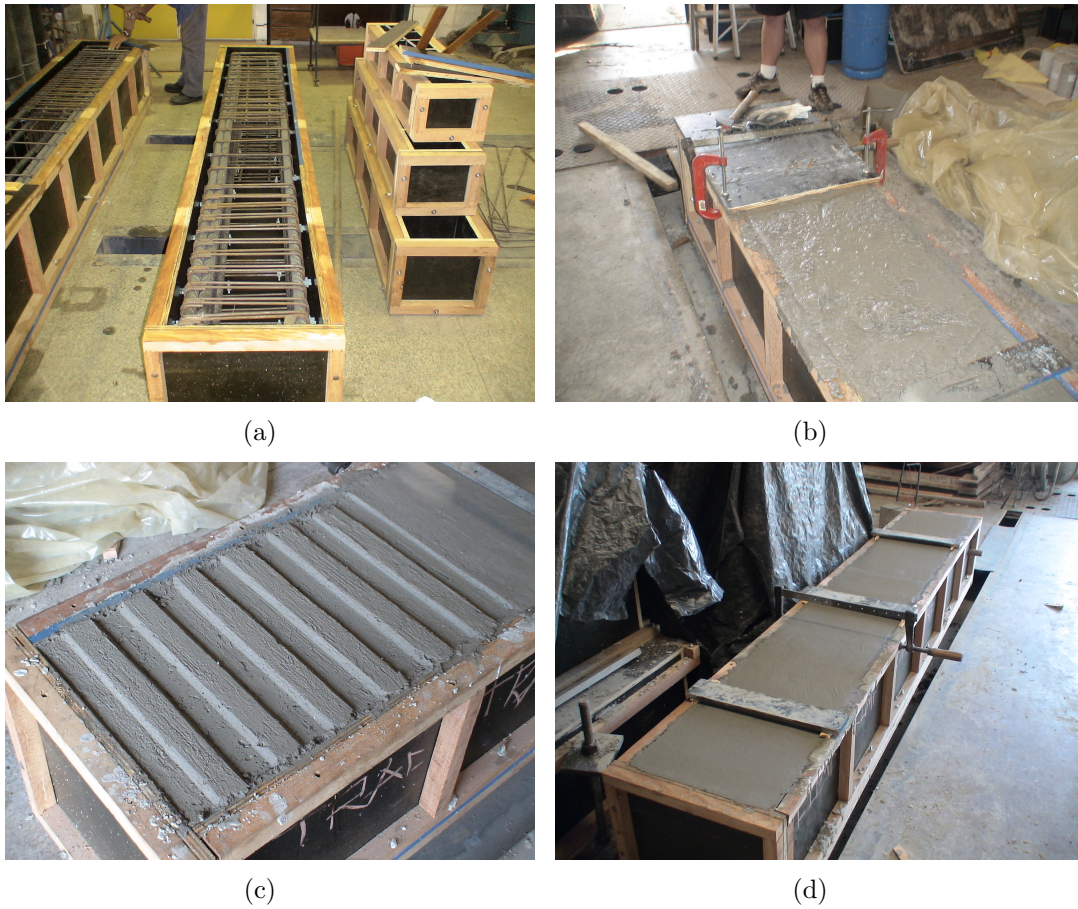
Figura 3.23: Moldagem dos pilares: (a) Armadura na fôrma; (b) Posicionamento da placa rugosa ; (c) Aspecto das chaves de cisalhamento; (d) Pilar acabado;
