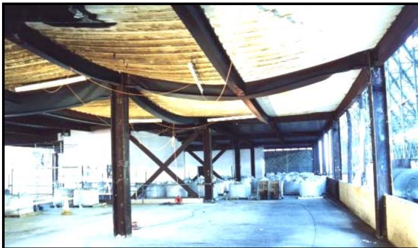
Figura 2.16 - Vista geral de um dos pavimentos e configuração deformada dos elementos estruturais após o incêndio. Fonte: LAMONT (2001).
