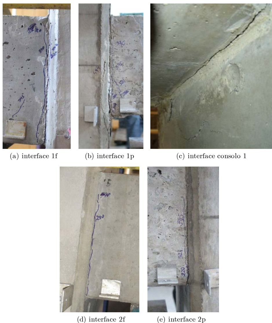
Figura 4.8 - Quadro de fissuração do modelo MBS1.
