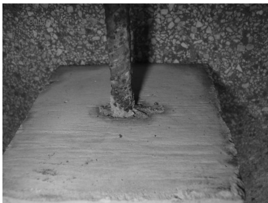
Ruptura por deslizamento da barra
