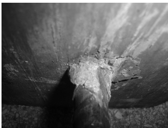
Ruptura por deslizamento da barra
