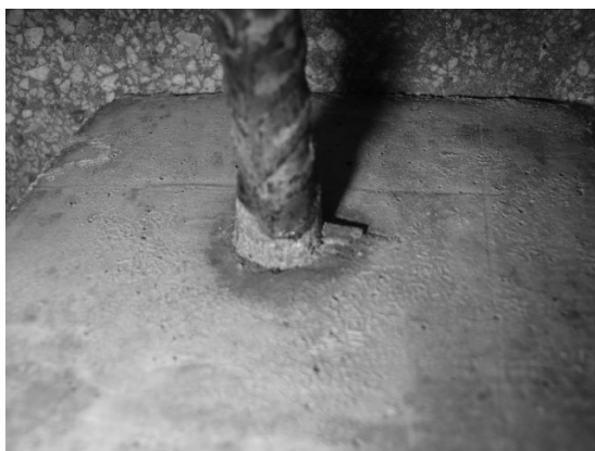
Ruptura por deslizamento da barra
