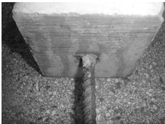
Ruptura por deslizamento da barra
