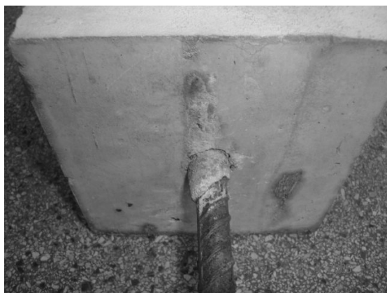
Ruptura por deslizamento da barra
