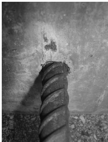
Ruptura por deslizamento da barra Vista inferior
