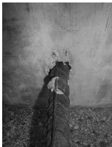
Ruptura por deslizamento da barra Vista inferior
