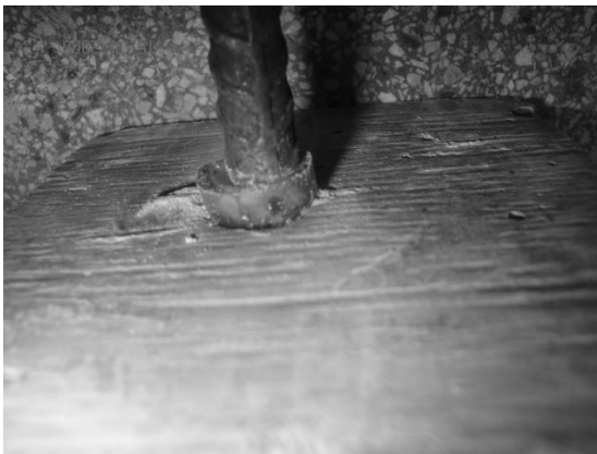
Ruptura por deslizamento da barra
