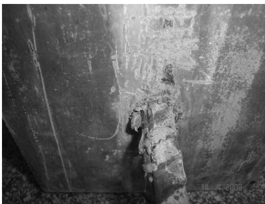
Ruptura por deslizamento da barra
