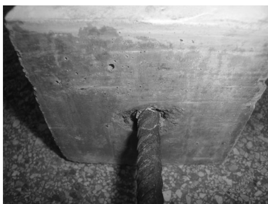
Ruptura por deslizamento da barra
