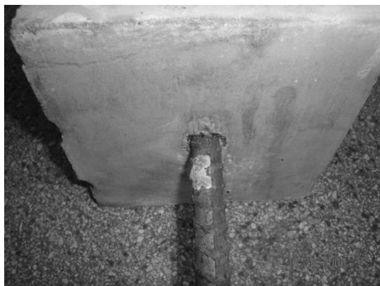
Ruptura por deslizamento da barra
