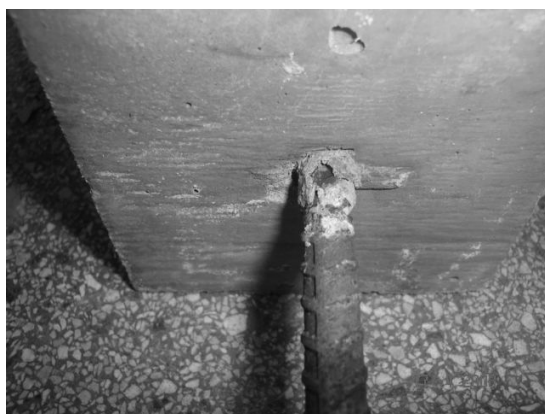
Ruptura por deslizamento da barra
