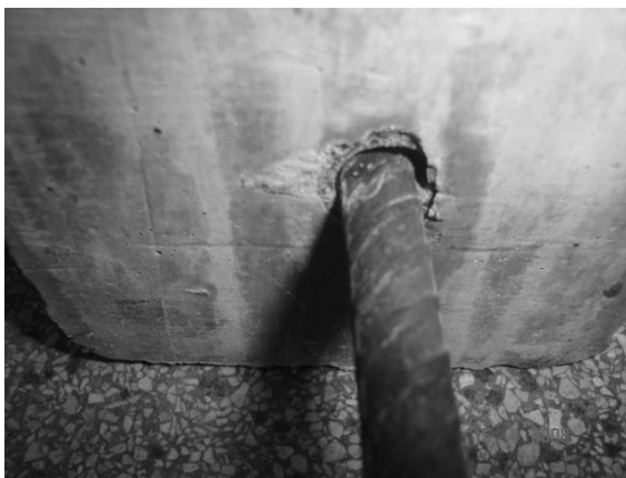
Ruptura por deslizamento da barra
