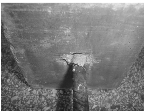
Ruptura por deslizamento da barra
