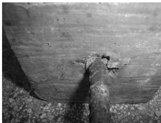
Ruptura por deslizamento da barra
