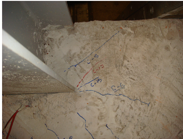
Figura 4.51 – Fissuras ao redor do pilar de canto - 7ª etapa de carregamento concentrado
