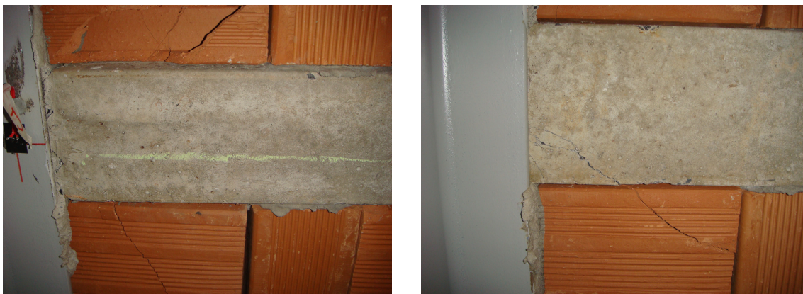
Figura 4.66 – Vista da ruptura das lajotas e vigotas - 9ª etapa de carregamento concentrado
