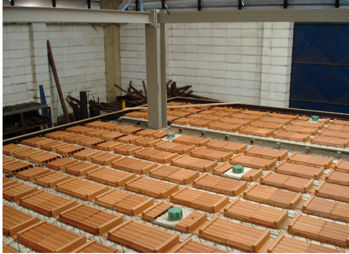
Figura 3.7 – Vista da laje pré-moldada bidirecional
