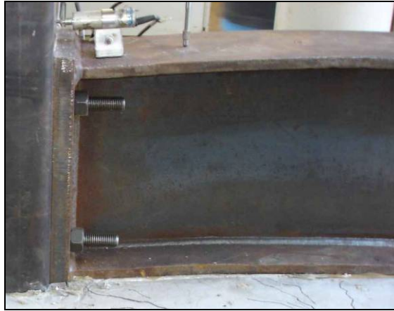
Figura 5-41 – Deformação localizada na mesa da viga de aço
