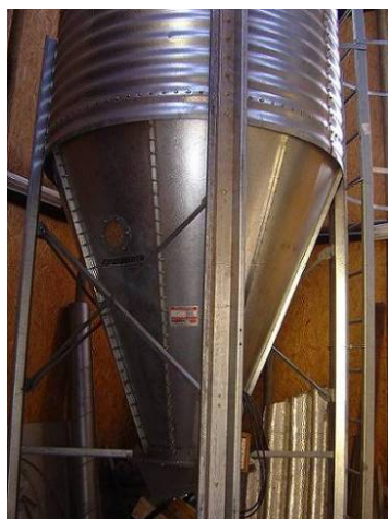
Figura 28 – Silo para armazenar os produtos ensaiados.
