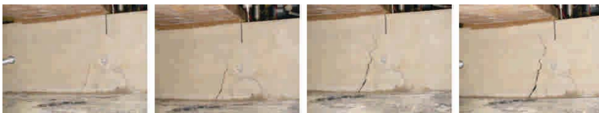
Figura 6.12 – Vista lateral da propagação da fissuração no modelo JS16SDM
