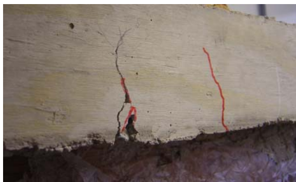
a) Fissuração na mesa de concreto verificada após 1 \times 10^6 ciclos para a carga P_{50\%}
