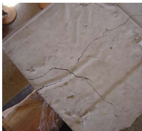
b) Fissuração da mesa de concreto ao longo do comprimento da viga.
