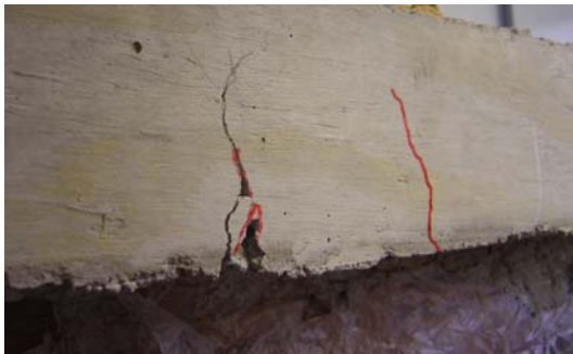
b) Fissuração da mesa de concreto após 1 \times 10^6 ciclos de carga aplicados - (viga VR11)
