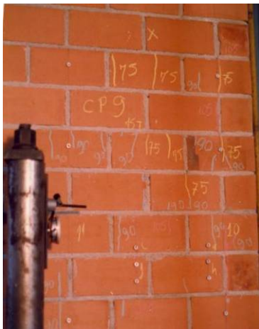
a) Detalhe da fissuração.
