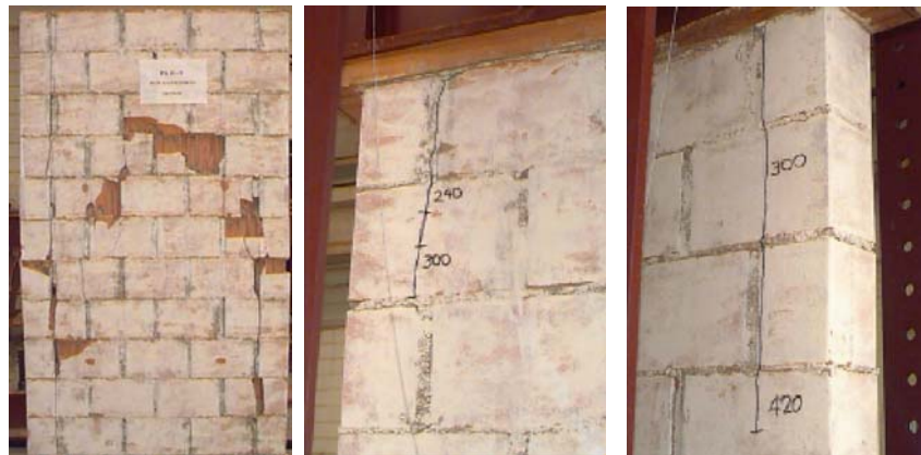
Figura 2.19 - Cenário pós-ruptura do painel de parede com blocos cerâmicos, Machado Jr. et al. (1999).
