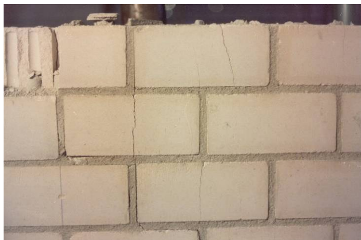
Figura 2.25 - Detalhe da fissuração pós-ruptura do painel de parede com blocos sílico-calcários, Franco (1987).
