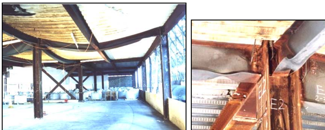
Figura 2.2 - Vista geral de um dos pavimentos e configuração deformada dos elementos estruturais após o incêndio. Fonte: SCI (2000).
