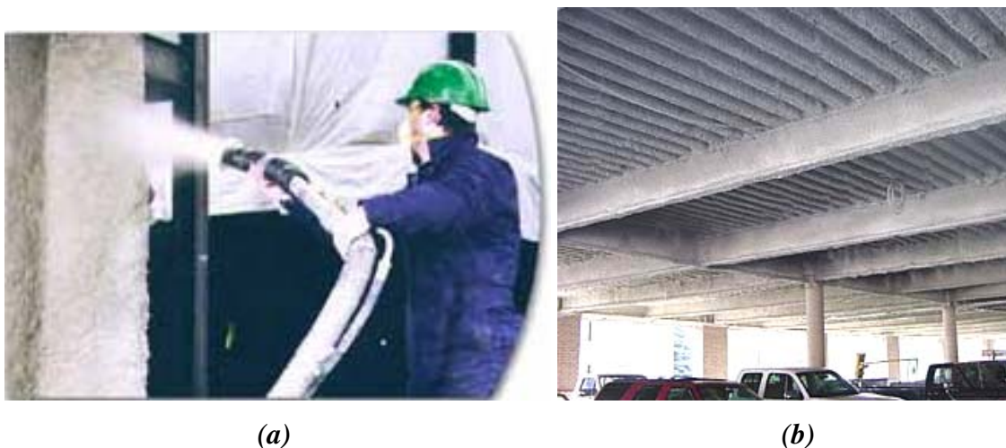
Figura 3.13 – Fibras projetadas (BLAZE-SHIELD®): (a) Operação de jateamento. Fonte: isolatek.com ; (b) Detalhe do acabamento. Fonte: sweets.construction.com .
