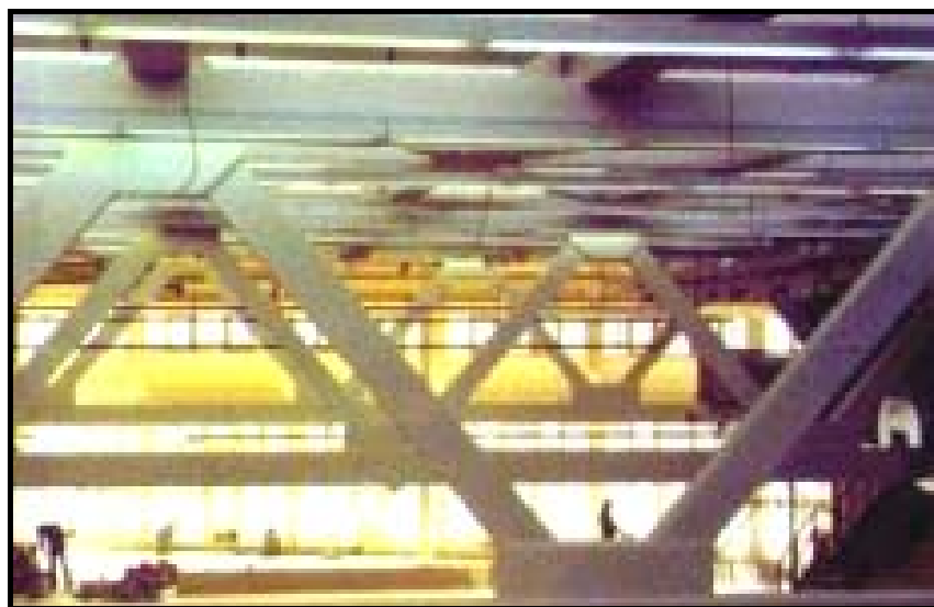
Figura 3.20 – Estrutura protegida com placas rígidas de painéis autoclavados.
