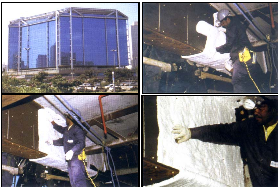
Figura 3.22 – Centro Empresarial do Aço protegido por manta de fibra cerâmica, São Paulo – SP: vista geral e detalhes da fixação da manta de fibra cerâmica em perfil soldado tipo I, por meio de pinos e arruelas de pressão. Fonte: DIAS (2002).
