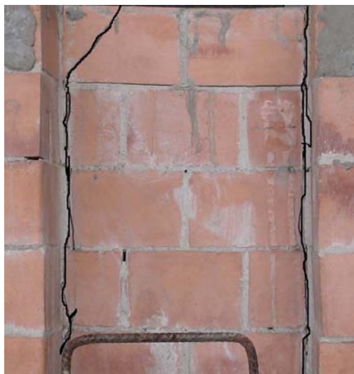
a) Fissuras realçadas no modelo M 03 AI-T
