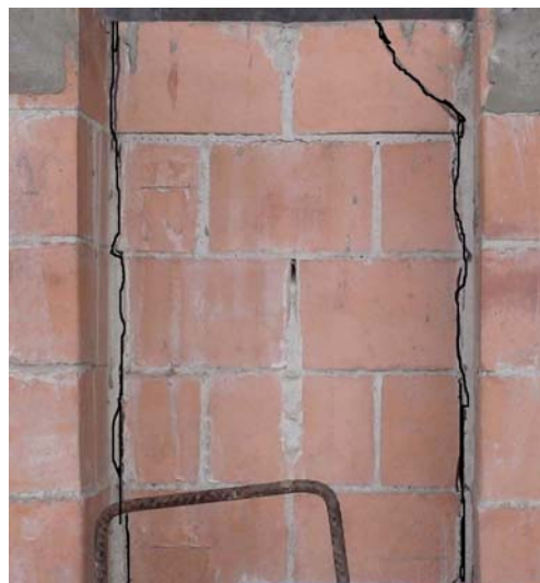
b) Fissuras realçadas no modelo M 04 AI-T
