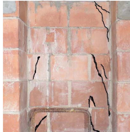
b) Fissuras realçadas no modelo M 05 AD
