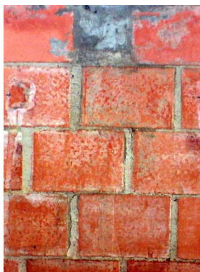
a) Fissuras quase invisíveis a olho nu (M 02 AI-T)
