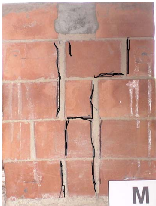
a) Fissuras realçadas no modelo M 05 AD
