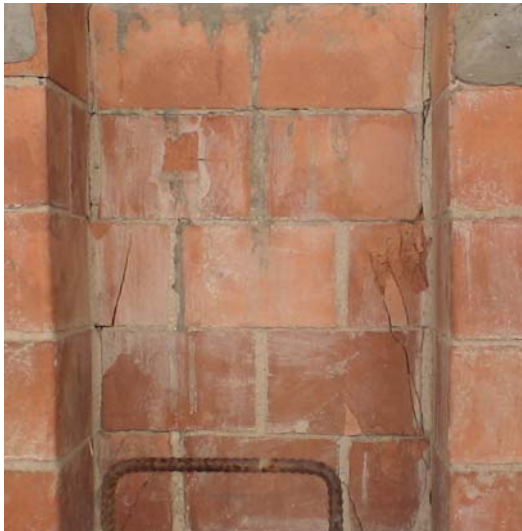
a) Fissuras sem marcação no modelo M 05 AD
