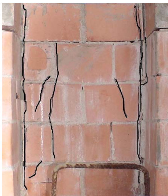
a) Fissuras realçadas no modelo M 02 AI-T
