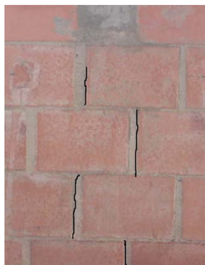
b) Fissuras realçadas no modelo M 02 AI-T
