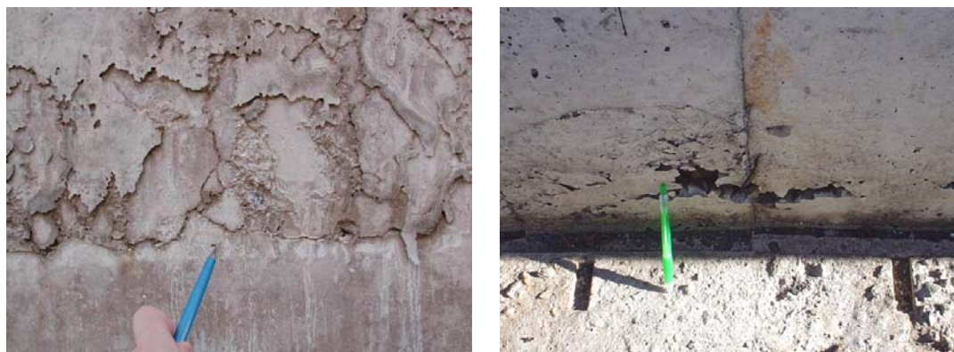
a) aspecto de uma junta de concretagem defeituosa
