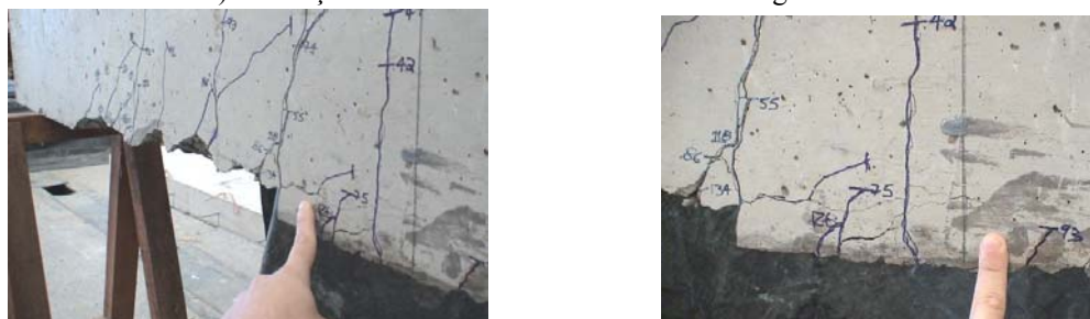
c) fissuração de ruptura da camada de cobertura da armadura
