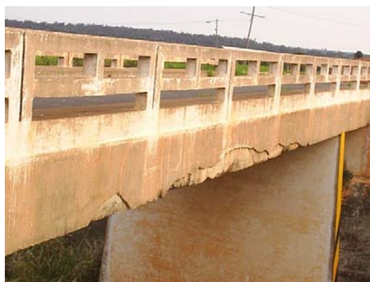
b) viga de viaduto danificada
