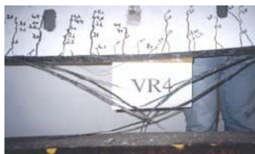
b) ruptura do reforço
