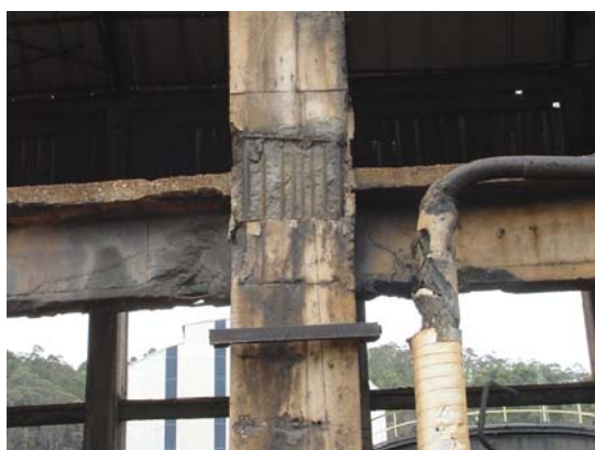
a) vigas e pilares danificados por incêndio
