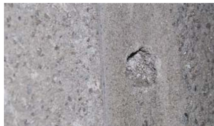
Figura 5.5. Falha de adensamento do bloco.
