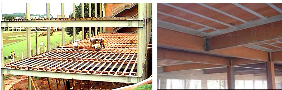
FIGURA 2.31 - Execução de uma laje com vigotas pré-moldadas em um edifício em estrutura metálica
