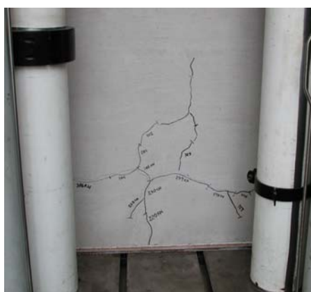
a) Fissuras espalhadas
