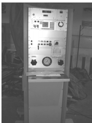
Figura 4.12: Sistema de controle da bomba hidráulica para alimentação dos atuadores
