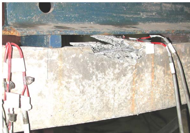
Figura 4.28 – Ruptura da viga VP-01-AD
