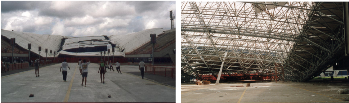
Figura 1.4 - Colapso da cobertura do Centro de Convenções de Manaus
