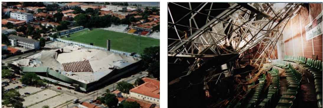
Figura 1.6 - Colapso de uma cobertura em Teresina
