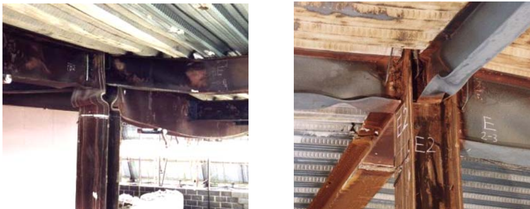
FIGURA 3.5: Configuração deformada dos elementos estruturais após o incêndio, LAMONT (2001).
