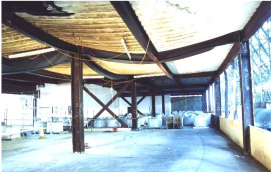
FIGURA 3.4: Vista geral de um dos pavimentos do Edifício Cardington após o incêndio, LAMONT (2001).
