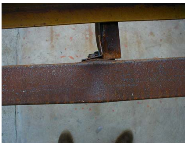
Figura 54 Detalhe em vista superior do modo de instabilidade distorcional ocorrido no travamento central no ensaio do conjunto 11 – Perfil Ue 350x85x25x2,65.
