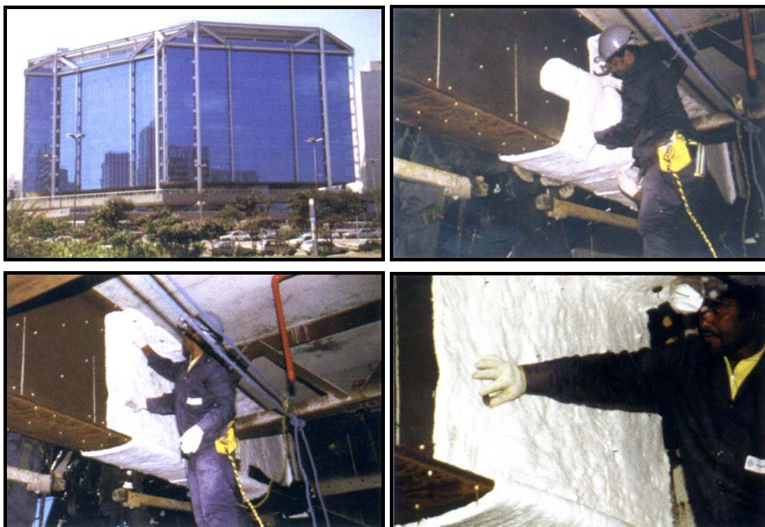
FIGURA 3.23: Centro Empresarial do Aço protegido por manta de fibra cerâmica, São Paulo – SP: vista geral e detalhes da fixação da manta de fibra cerâmica em perfil soldado tipo I, por meio de pinos e arruelas de pressão. Fonte: Dias (2002).
