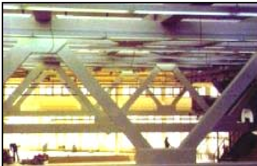
FIGURA 3.17: Estrutura protegida com placas rígidas de painéis autoclavados.
