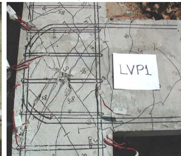
Fissuração em relação às armaduras
