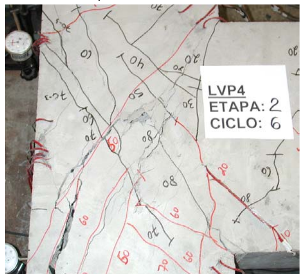
Etapa 2 – ciclo 6: Queda de resistência do nó
