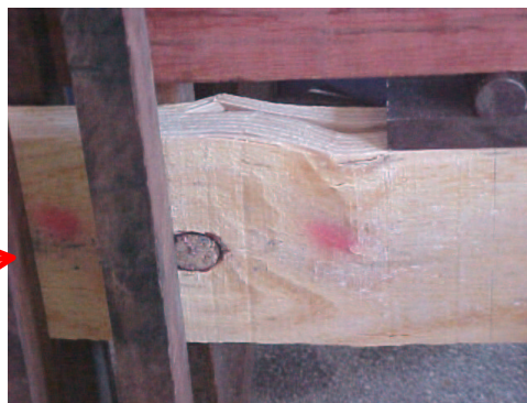
Figura 118 – Detalhe do esmagamento das fibras.
