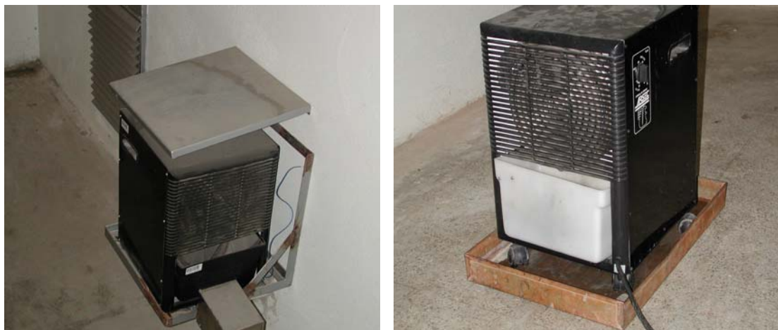
Figura 5.26 – Desumidificadores da câmara climatizada
