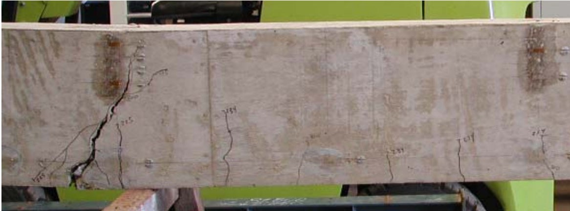
Figura 6.72 – Detalhes da fissuração da V_60_L/6, do lado esquerdo.
