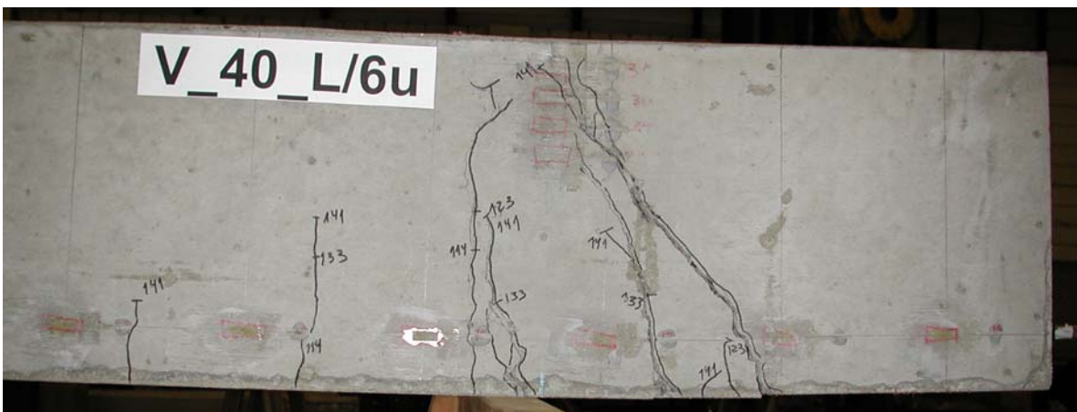
Figura 6.99 – Detalhes da fissuração da V_40_L/6u.
