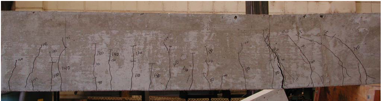
Figura 6.66 – Detalhes da fissuração da V_60_L/3.
