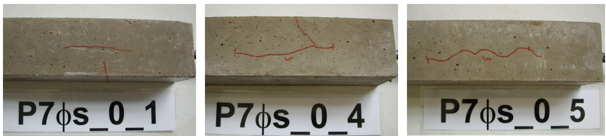
Figura 5.8 – Fissuração dos modelos do Grupo 2.
