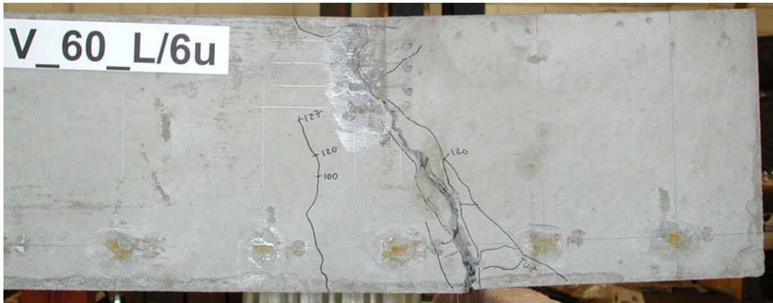
Figura 6.104 – Detalhes da fissuração da V_60_L/6u.
