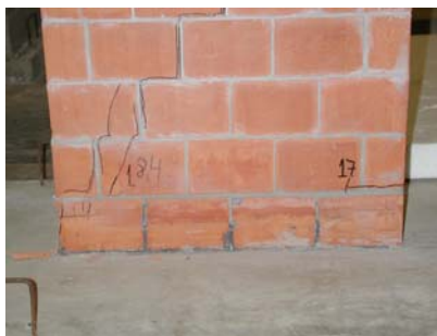
FIGURA 4.3-36 Fissuração na base da parede P1 do modelo PPSG2.
