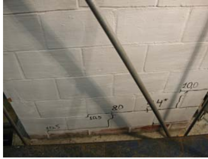
FIGURA 4.2-17 Fissuração na base oriunda da flexão do painel: modelo PICG1.
