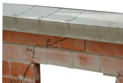
FIGURA 4.3-25 Fissuração do lintel do modelo PPSG2.
