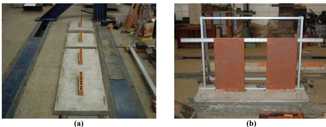
FIGURA 3-25 Construção dos painéis: (a) Primeira fiada colada de dois painéis isolados e um painel porta; (b) Utilização do gabarito em alumínio durante a construção de um painel porta.
