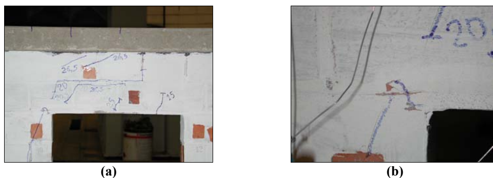
FIGURA 4.3-16 Lintel do modelo PPSG1: (a) Vista geral da fissuração; e (b) Detalhe do canto comprimido.
