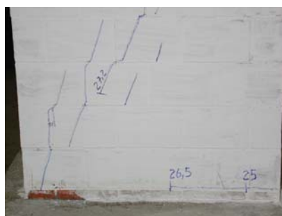
FIGURA 4.3-18 Base da parede P1 do modelo PPSG1: prolongamento da fissura horizontal e fissuração diagonal.
