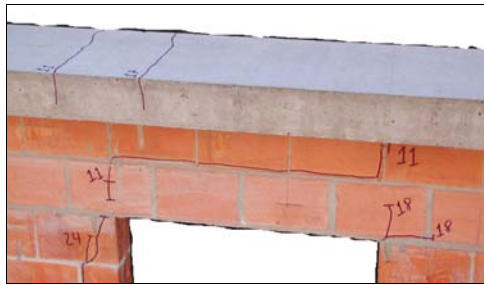
FIGURA 4.4-24 Fissuração do lintel: modelo PPCG2.
