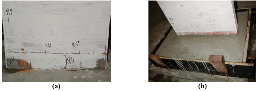
FIGURA 4.2-13 Procedimento de reforço do modelo PICG1: (a) Distribuição de fissuras e base sendo preparada para grauteamento; (b) Grauteamento recém realizado.
