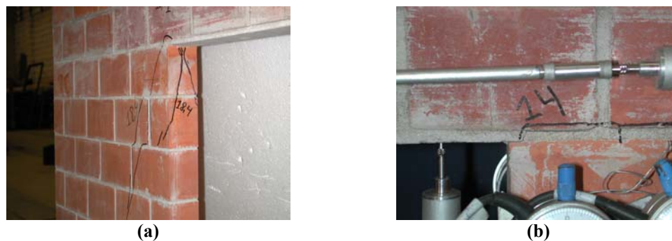
FIGURA 4.3-27 Fissuração nos cantos da abertura – modelo PPSG2: (a) Canto comprimido; e (b) Canto tracionado.
