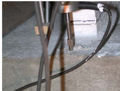
FIGURA 4.3-11 Detalhe da abertura da fissura no canto tracionado da parede P2: modelo PPSG1.
