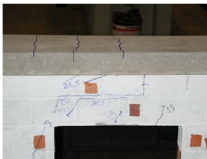
FIGURA 4.3-8 Detalhe da fissuração na laje de topo: modelo PPSG1.
