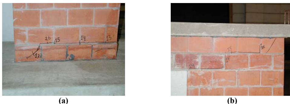
FIGURA 4.3-34 Fissuração da parede P2 do modelo PPSG2: (a) Base e (b) Topo.
