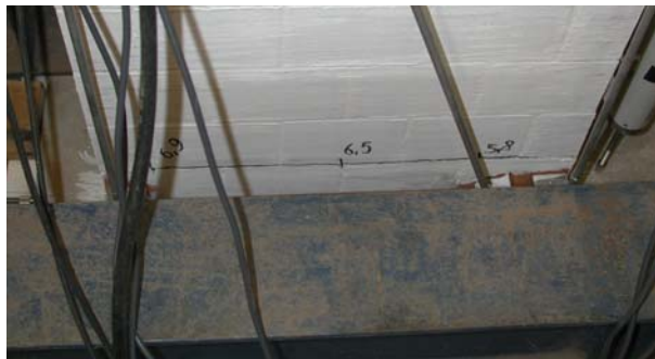
FIGURA 4.2-4 Fissuração observada na base do painel: modelo PISG1.
