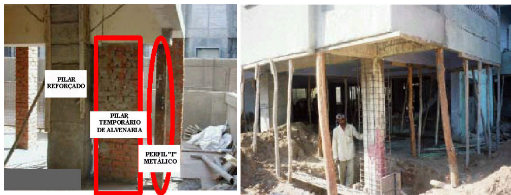
Figura 2.1: Tipos de sistemas de alívio de carregamento de pilares - (PAREEK, HAYASHI, SAWADA, 2002)
