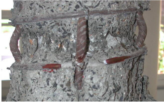
(b) detalhe do estribo rompido
