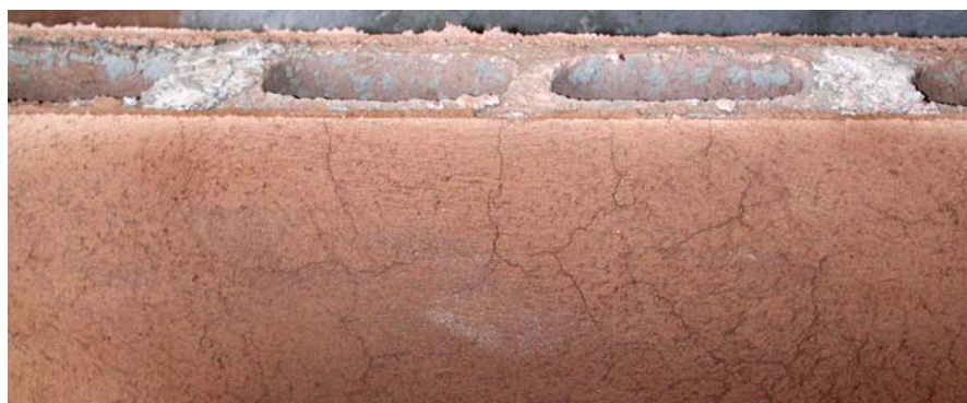
Figura 5.4 - Retração no revestimento de argamassa reciclada
