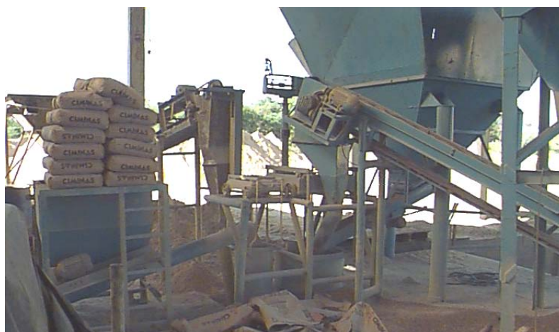
Figura 4.2 - Vista dos silos e balanças instalados no funil
