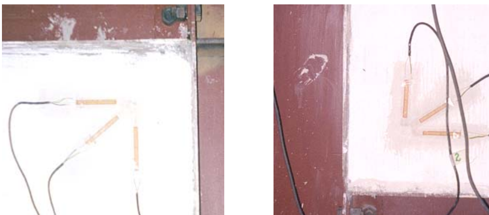
FIGURA 3.15 - Extensômetros: a) roseta do canto superior direito e b) roseta do canto inferior esquerdo
