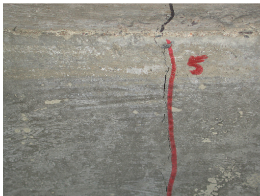
Figura 6.32 – Abertura da fissura iniciada na etapa 5 – Etapa real da foto: Etapa 8.
